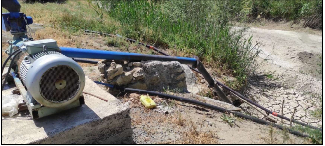
Şekil 3. 8. Araştırma sahasında kullanılan su motorundan bir görünüm, (Ahrözü Mahallesi)
