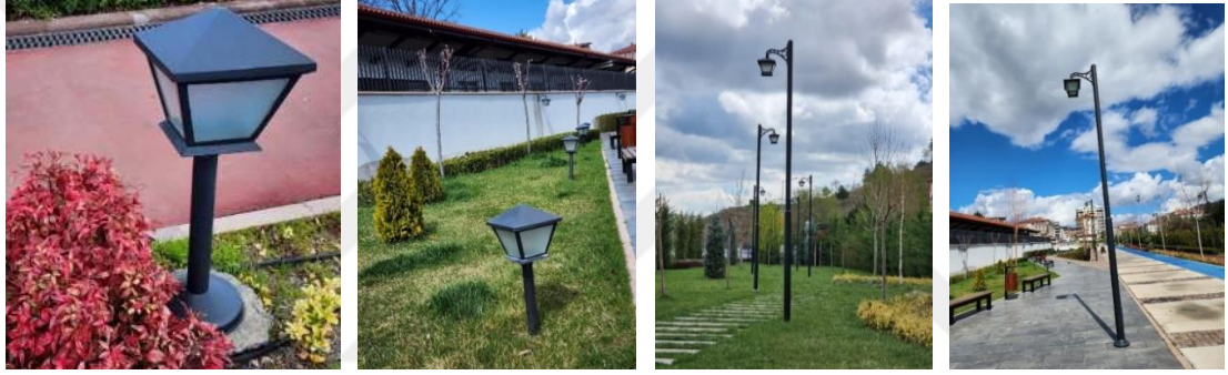
Şekil 5.12 Yerden ve tepe aydınlatma elemanları
