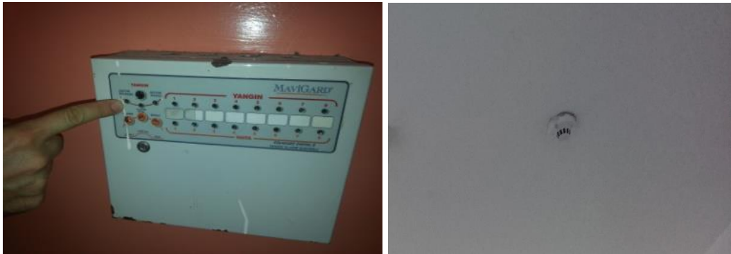
Şekil 4.6. Yangın algılama ve uyarı sistemlerinin çalışmaması
