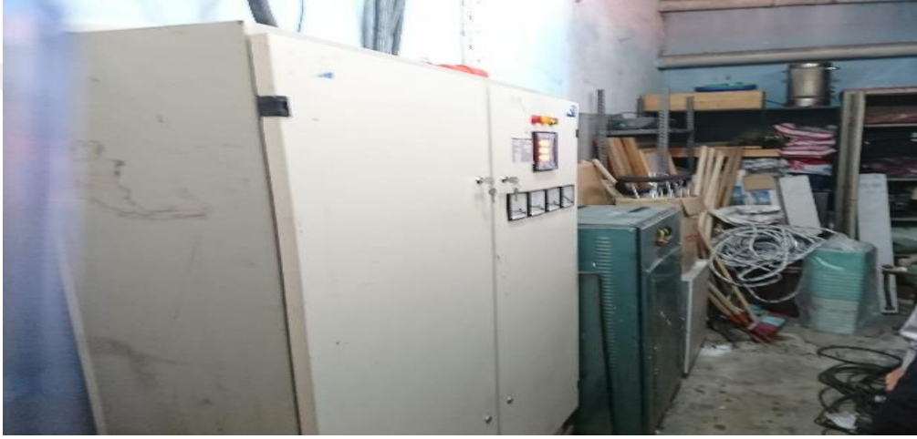
řekil 4.2. Elektrik panolarının bulunduęu ortamda yanıcı maddelerin bulunması
