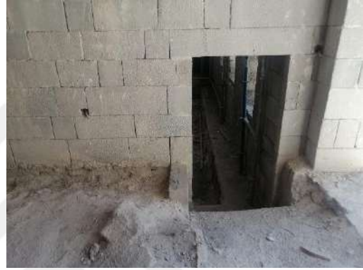
Şekil 6.109 Mutfaktan doğu kanat bodrumuna giden kapı boşluğu
