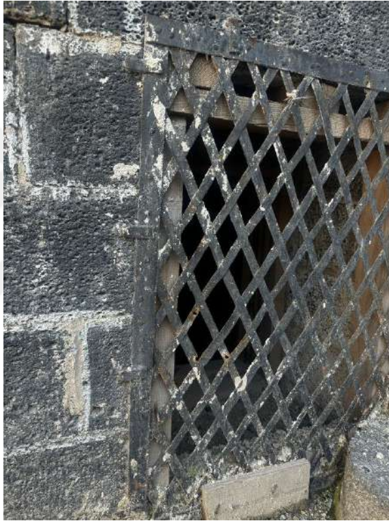
Şekil 6.139 Doğu kanat bodrum kat penceresi demir parmaklığı
