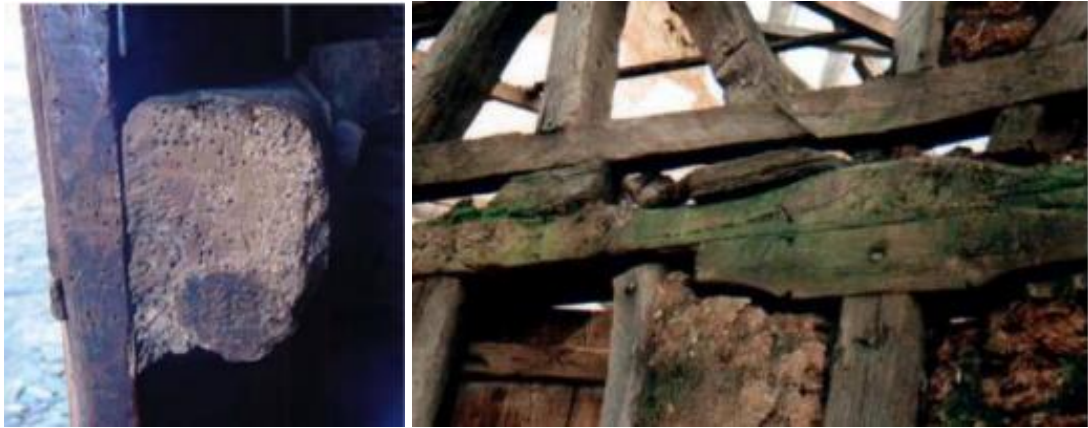
Şekil 196. Solda Cumalıkızık konutlarında böcek ve kurt etkisi; Sağda Cumalıkızık konutlarında bakteri ve mantar etkisi (Perker & Akıncıtürk, 2006).
