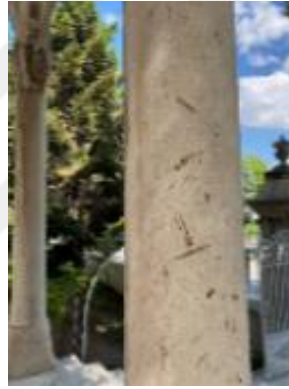
Şekil 125. Taş sütunlarda görülen mekanik hasarlar (Ünal, 2023)
