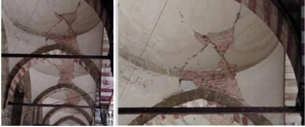
Şekil 79.Fatih Külliyesi-İstanbul, Kubbe hasarları (Vatan Kaptan, 2010).
