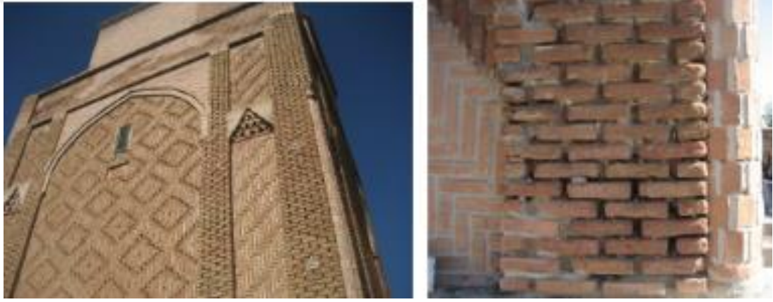
Şekil 48. Kayseri Melikgazi Türbesi duvarlarında görülen derz boşalması (Karakuş, 2012).
