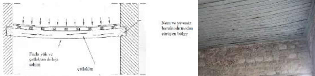
Şekil 69. Solda bir döşemenin sehim yapması, Sağda Edirne Atik Ali Paşa Camii ahşap tavanının sehim yapması (Karakuş, 2012)
