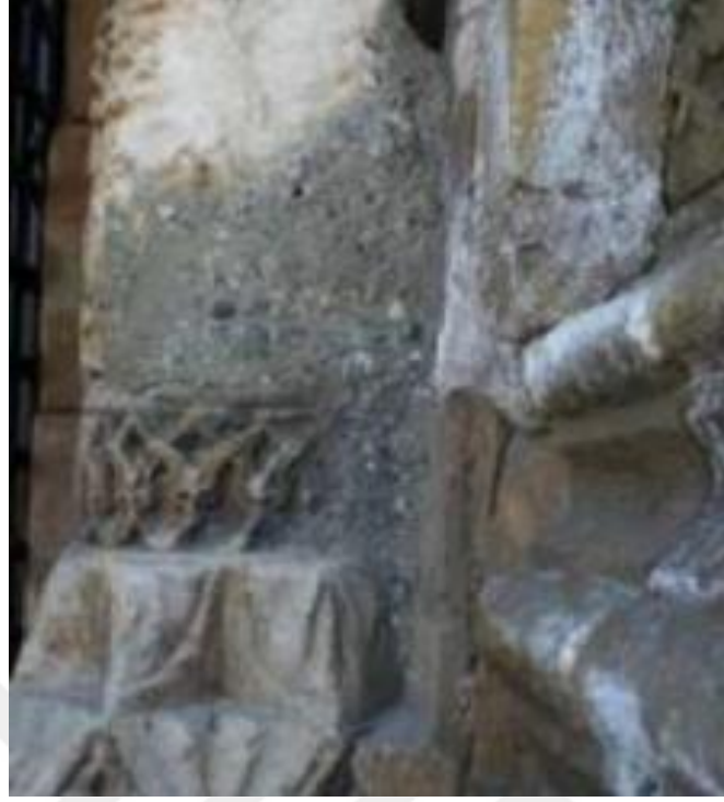
Şekil 151. Taş yapıda hatalı çimento kullanımı ile meydana gelen deformasyon (Tayşi, 2021).
