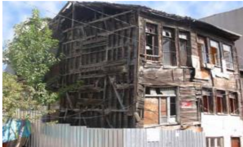
Şekil 187.Hatalı taşıyıcı sistem kurgusunun yapı hasarına etkisi (Saatçi & Gürsoy).
