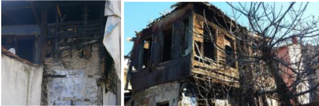
Şekil 193. Balıkesir-Ahşap yapıda yangın etkisiyle malzemenin bozulması (Ağan, 2017).
