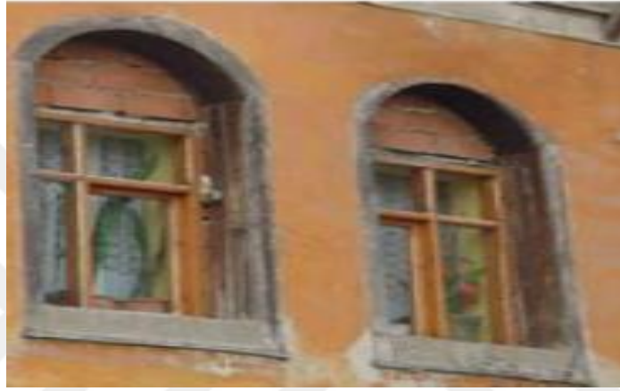
Şekil 188. Bursa-Cumalıkızık Geleneksel Konutlarda Hatalı Onarım Etkisi (Perker & Akıncıtürk, 2006).
