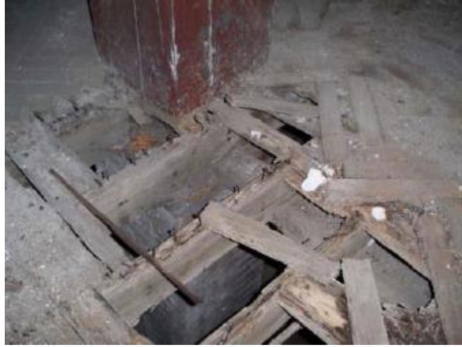
Şekil 192. İstanbul-Büyükada Rum Yetimhanesi, Su ve Nemden Dolayı Ahşap Elemanlarda Bozulma (Yıldırım, 2023)
