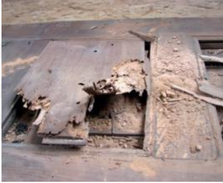
Şekil 195. İstanbul-Nuruosmaniye Cami, Ahşaptaki mantarlaşma, çürüme ve böceklenme (Durak, 2012).
