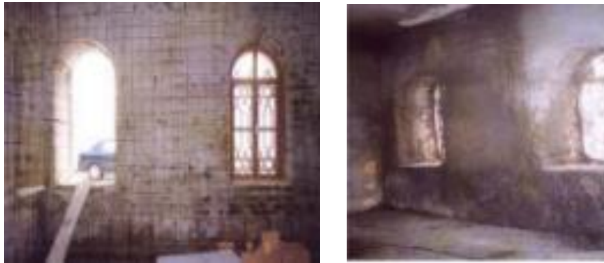
Şekil 58. Kabataş Erkek Lisesi duvarlarına yapılan geri dönüşümü mümkün olmayan püskürtme beton uygulaması, İstanbul (Mahrebel, 2006).
