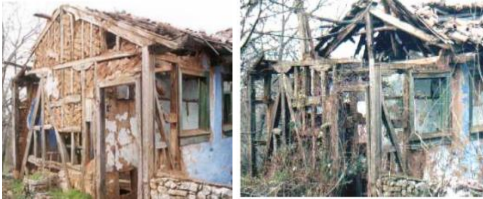
Şekil 189. Bursa-Cumalıkızık Geleneksel Konutlarda Bakımsızlık ve Terk Etkisi (Perker & Akıncıtürk, 2006).
