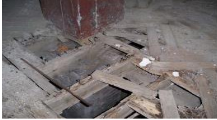
Şekil 70. Yetimhane, Büyükada-İstanbul, Yığma kâgir yapıda ahşap döşeme hasarı (Vatan Kaptan, 2010).
