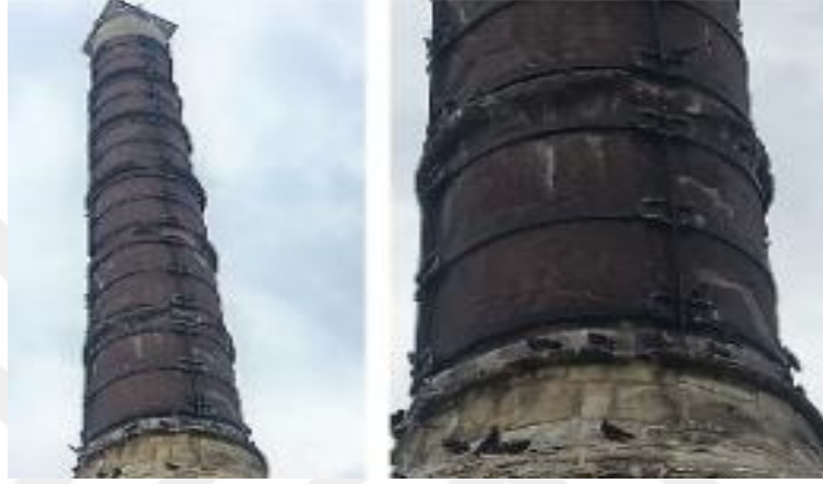
Şekil 92. ÜstteSütündaki çatlakın paslanmaz çelik çemberler ile sağlamlaştırılması; Altta İstanbul- Çemberlitaş, Metal gerilerle yapılan çemberleme örneği (Yüce, 2021).
