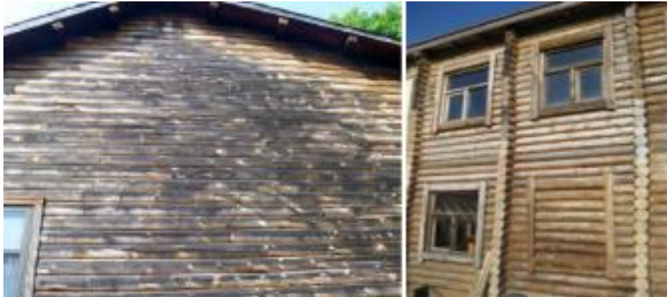
Şekil 186. İklimsel etmenlerden kaynaklı solda cephede kararma, sağda güneş alan kısımda renk değişimi (Saatçi & Gürsoy).
