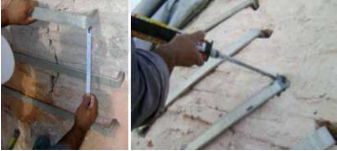
Şekil 52. İstanbul-Fatih Camii, Paslanmaz çelik kenetlerle orta genişlikte çatlak onarımı (Çılı & Yıldız, 2013).
