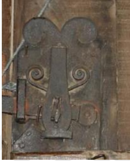
Şekil 194.Cumalıkızık Ahşap Yapılarında Korozyon Etkisi (Perker & Akıncıtürk, 2006).
