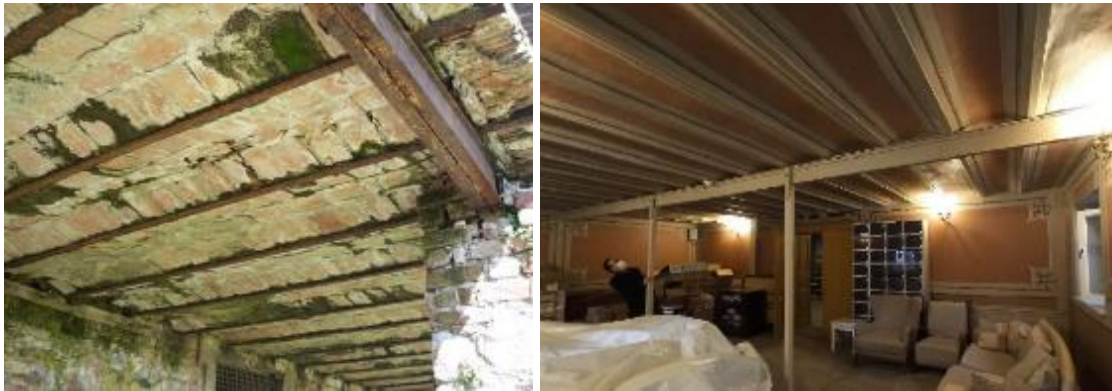
Şekil 71. Solda Yetimhane, Büyükada-İstanbul, Volta döşeme hasarı (Vatan Kaptan, 2010); Sağda Yıldız Hamidiye Camisi'ne ait geri döndürülebilir volta altı destek putrel kirişi uygulaması (Yalçın, 2022).
