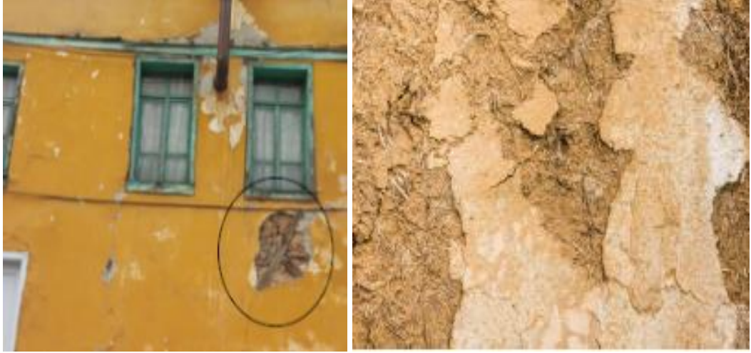
Şekil 174.Solda sıva harcında dökülmeler sonucu malzeme kaybı, sağda sıva harçlarında ufalanma (Ağan, 2017)
