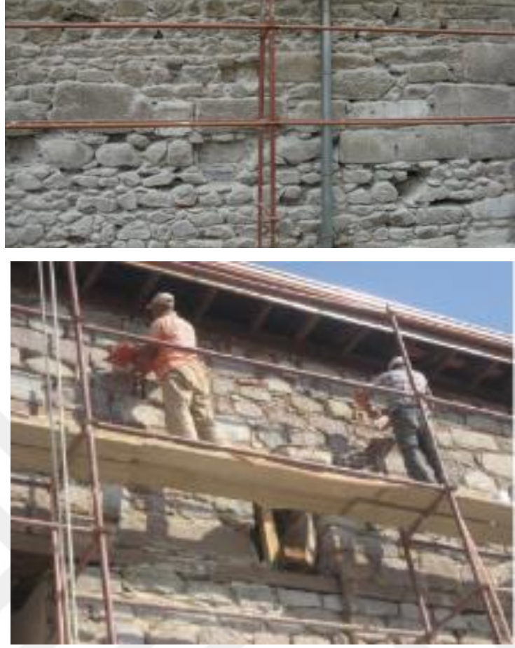
Şekil 181. Ankara-Altındağ, Arslanhane Camii; Solda boşalmış derzler, sağda yeniden derzleme (Karakuş, 2012).
