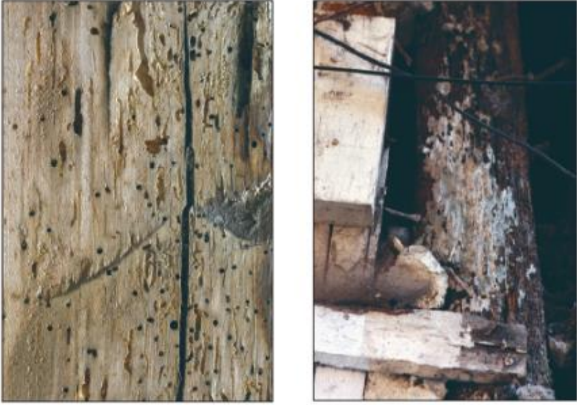
Şekil 197. Solda böcekleri ahşap yüzeyinde meydana getirdikleri uçma delikleri ve galeriler; Sağda Ahşap taşıyıcıda böcek ve mantarın meydana getirdiği tahribat (İ.B.B., 2009).
