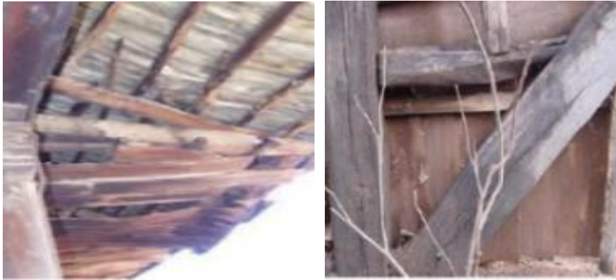
Şekil 191. Solda ahşap yapı elemanlarında su ve nem etkisiyle meydana gelen deformasyonlar (Karaman & Zeren, 2010); Sağda Cumalıkızık konutlarında meydana gelen deformasyonlar (Perker & Akıncıtürk, 2006).
