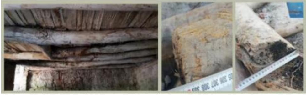
Şekil 105. Düz çatılı geleneksel bir Diyarbakır Evi örneğinde ahşap kirişlerde bozulma ve esnemeler (Dabanoğlu & Çağlayan, 2024).
