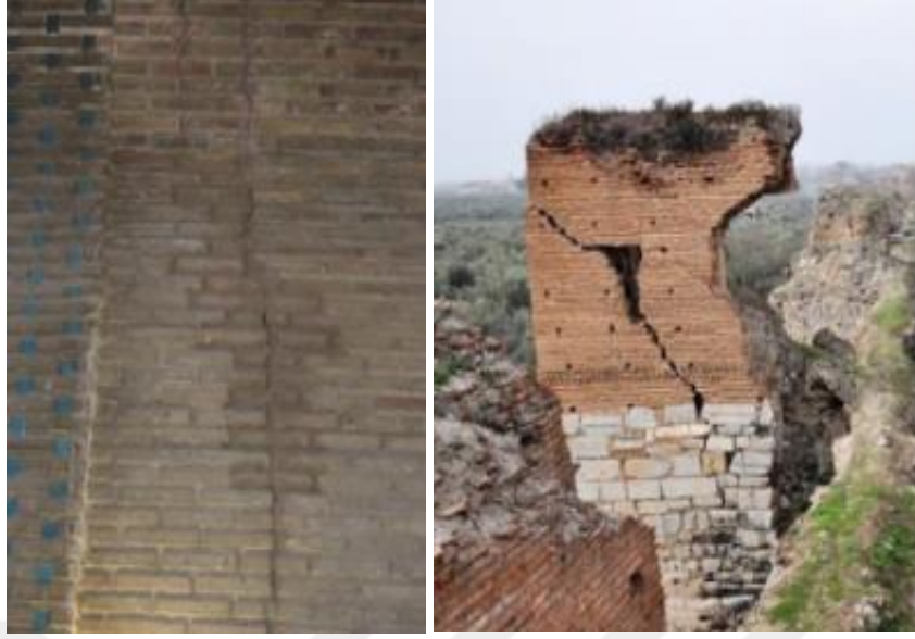
Şekil 127. Solda Konya İnce Minareli Medrese, Sağda Bursa İznik Surları Çatlakları (Yurttaş, 2018).
