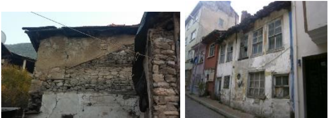
Şekil 176. Solda harçlarda rötire çatlağı; Sağda sıva harçlarında kirlilik (Ağan, 2017).
