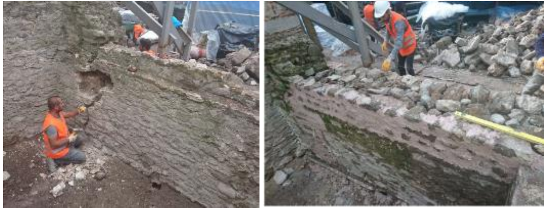
Şekil 50. İstanbul-Helvacıbaşı İskenderağa Cami son cemaat kısmı duvarlarındaki derin çatlakların çürütme yöntemiyle onarımı (Yüce, 2021).
