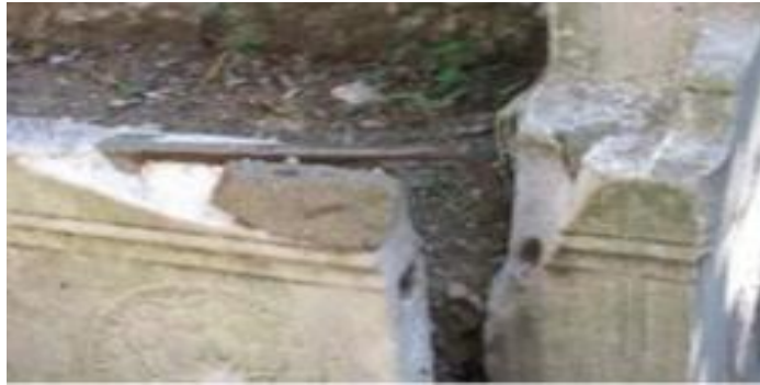
Şekil 132. Metal kenetin korozyonu sonucu oluşan patlama (Öcal & Dal, 2012).
