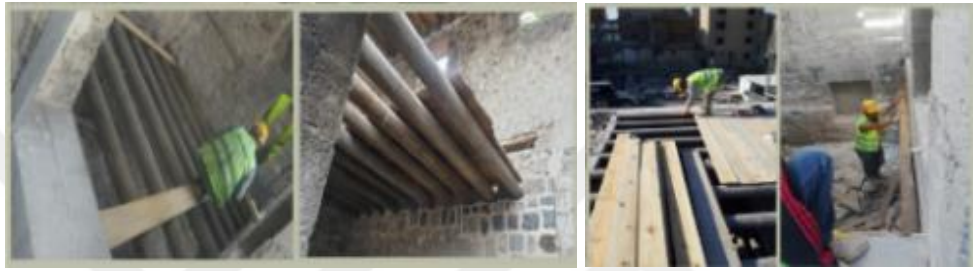
Şekil 106. Düz çatıda geri döndürülemez bir uygulama- Ahşap malzemenin tamamen yenilenmesi Diyarbakır-Suriçi/Geleneksel bir Diyarbakır Evi Örneği (Dabanoğlu & Çağlayan, 2024).
