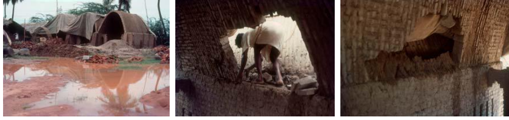
Fotoğraf 38: 9. Sağanak yağmur sonrası yapıda oluşan hasarlar
