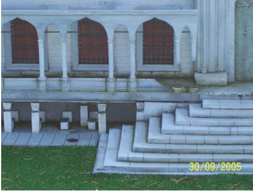
Şekil 25. Sultan Ahmet Camii'nde Görülen Hasar Örneği (KUTAY, 2005).
