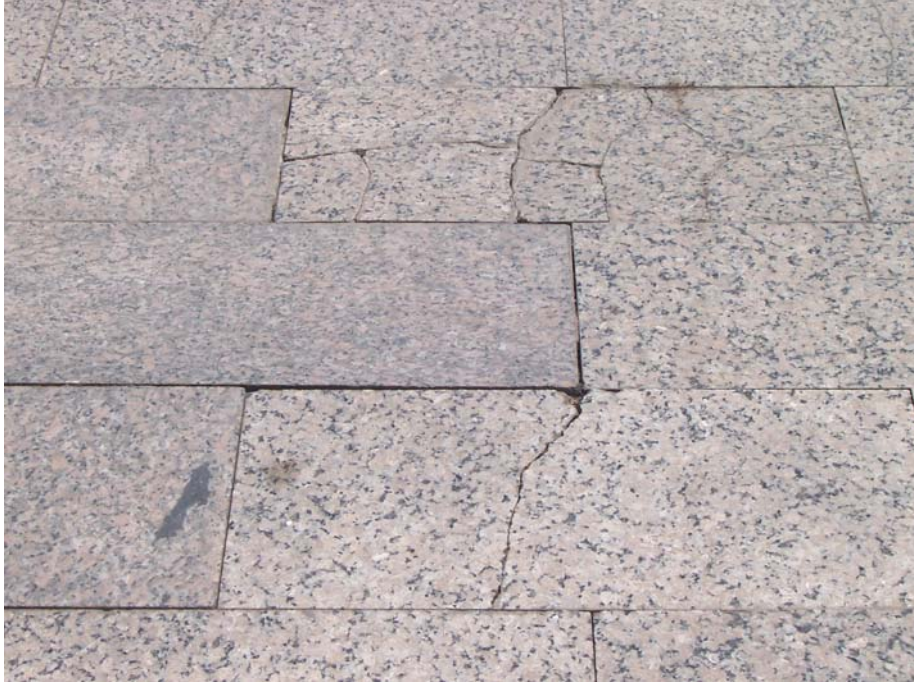
Şekil 19. Granit Döşemelerde Görülen Çatlama ve Bozulmalar
