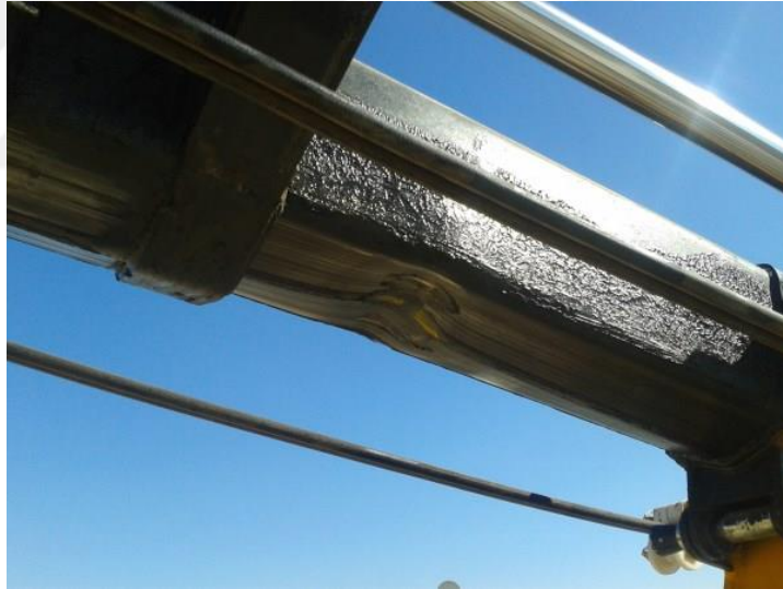
Şekil 3.27. Katlanır bomlu mobil hidrolik vinçte yorulmanın etkisi
