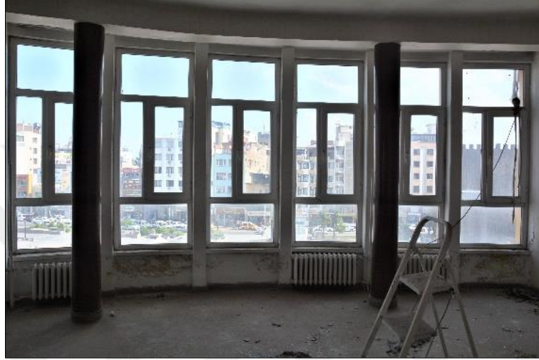
Şekil 4.106. Lojman katında bakımsızlığa bağlı duvar ve döşemelerde oluşan kısmi bozulmalar
