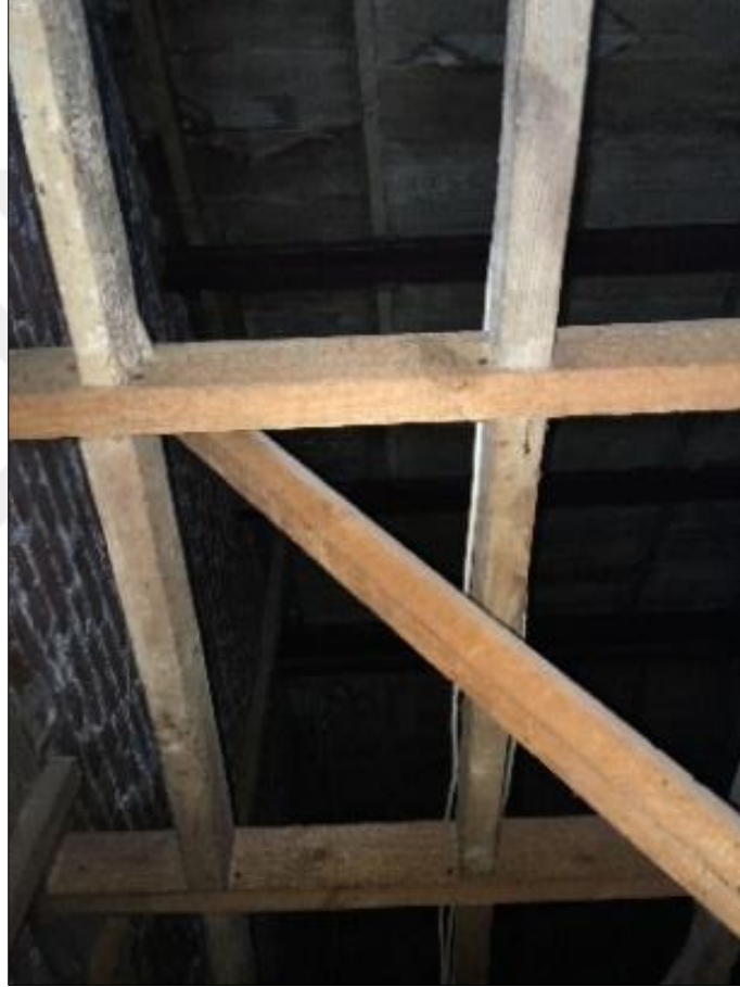
Şekil 4.108. Dilan sineması salon 1 üzerindeki ahşap çatı elemanlarında meydana gelen kısmi bozulma
