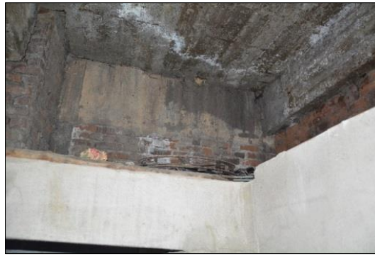
Şekil 4.121. Makine dairesinde neme bağlı oluşan bozulmalar
