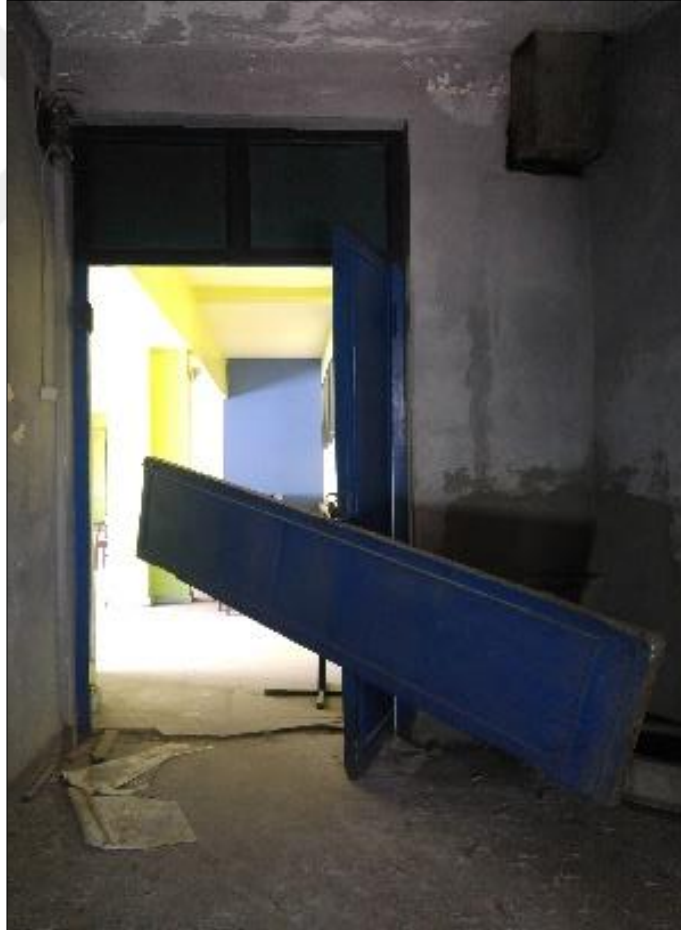
Şekil 4.110. Ahşap pencere ve kapılarda Bakımsızlık ve kullanıcı etkisiyle meydana gelen bozulma
