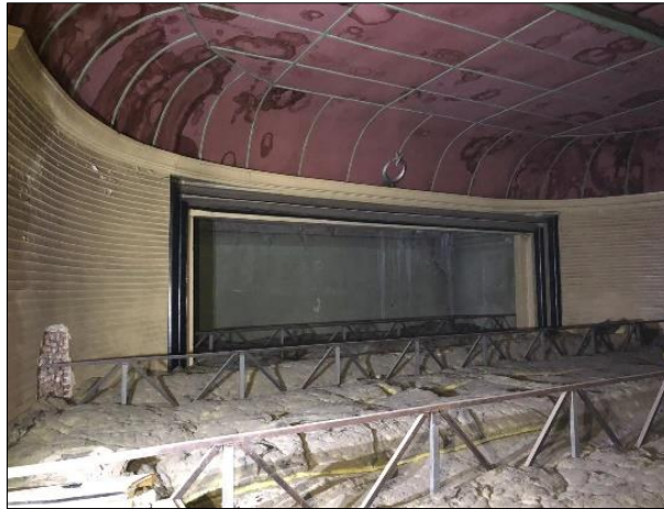
Şekil 4.103. Loca katında meydana gelen yüzey ve doku kaybı hasarları
