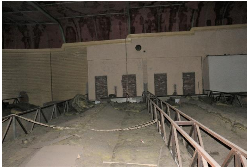
Şekil 4.112. Kapatılan loca katı döşemesinde oluşan bozulmalar
