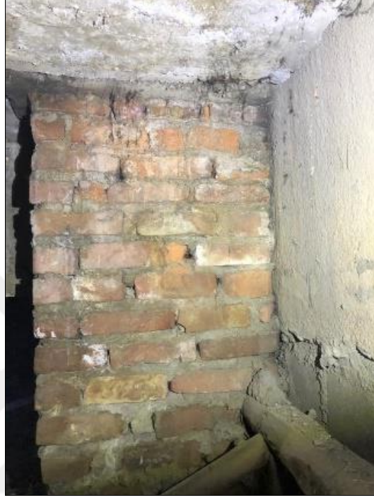
Şekil 4.120. Makine dairesinde neme bağlı oluşan bozulmalar
