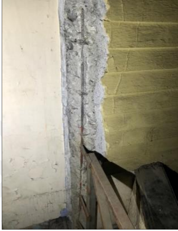
Şekil 4.102. Loca katında meydana gelen yüzey ve doku kaybı hasarları
