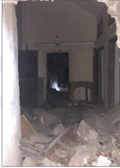
Şekil 4.78. Koridorda meydana gelen hasarlar
