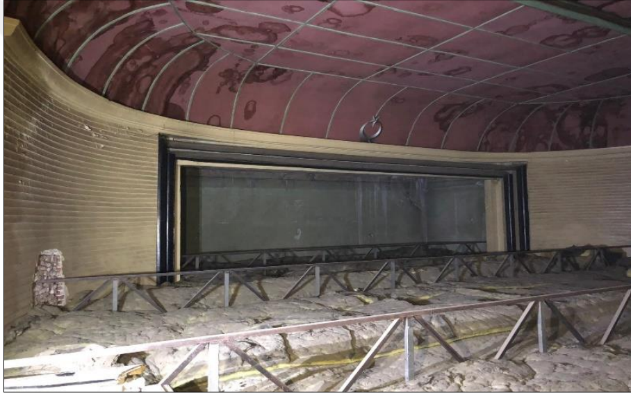
Şekil 4.113. Yapı Elemanlarına yapılan aykırı müdahale örneği loca katının işlevsizleştirilmesi
