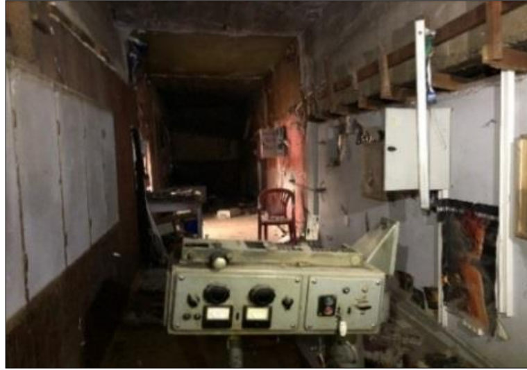
Şekil 4.38. Dilan Sineması 500 kişilik salon makine dairesi
