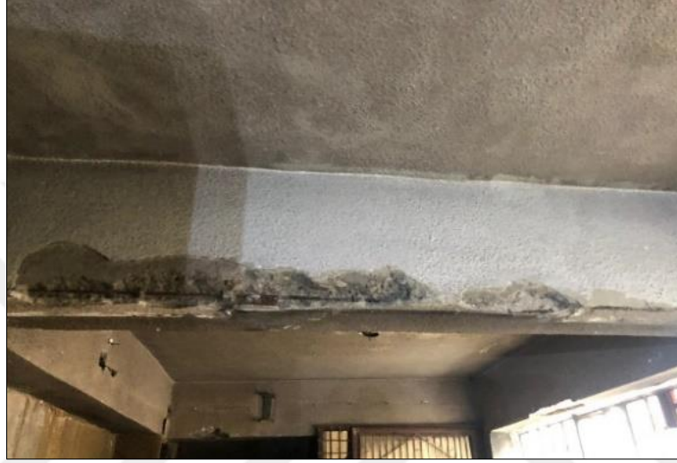
Şekil 4.96. Dilan sineması zemin kat koridorlarındaki kirişlerdeki sıva kayıplarına bağlı oluşan bozulmalar
