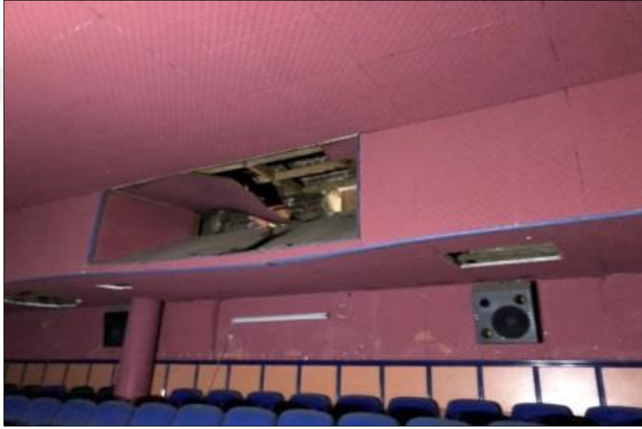
Şekil 4.99. Salon 1'de asma tavan kaplamasında ve ahşap kirişlerde meydana gelen bozulmalar
