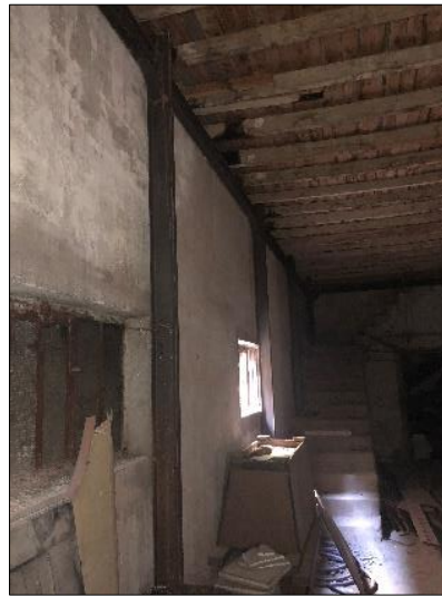
Şekil 4.89. Ahşap kirişli döşemede oluşan sehim, çürüme
