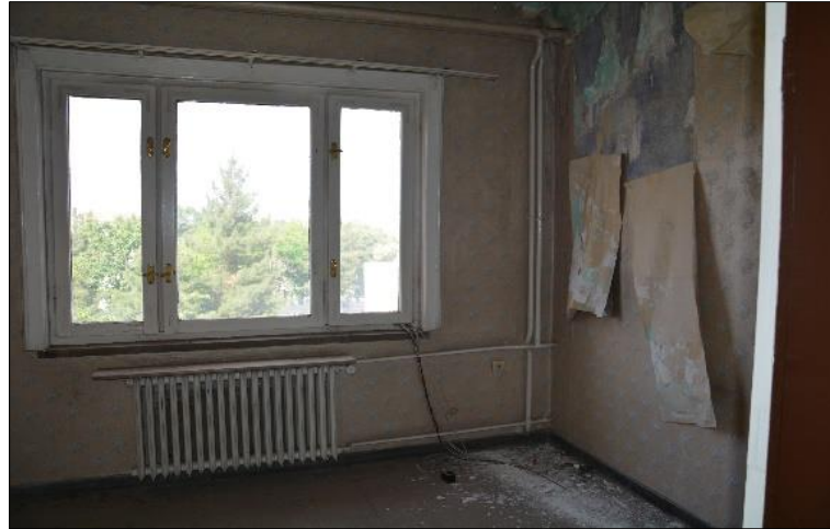
Şekil 4.107. Lojman katında bakımsızlığa bağlı duvar ve döşemelerde oluşan kısmi bozulmalar
