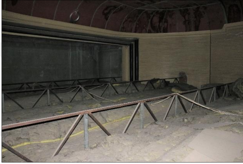
Şekil 4.111. Kapatılan loca katı döşemesinde oluşan bozulmalar
