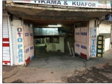
Şekil 4.81. Döşemelerdeki doku kaybı hasarları
