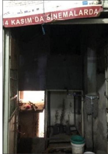
Şekil 4.70. Malzeme kaybı hasarları
