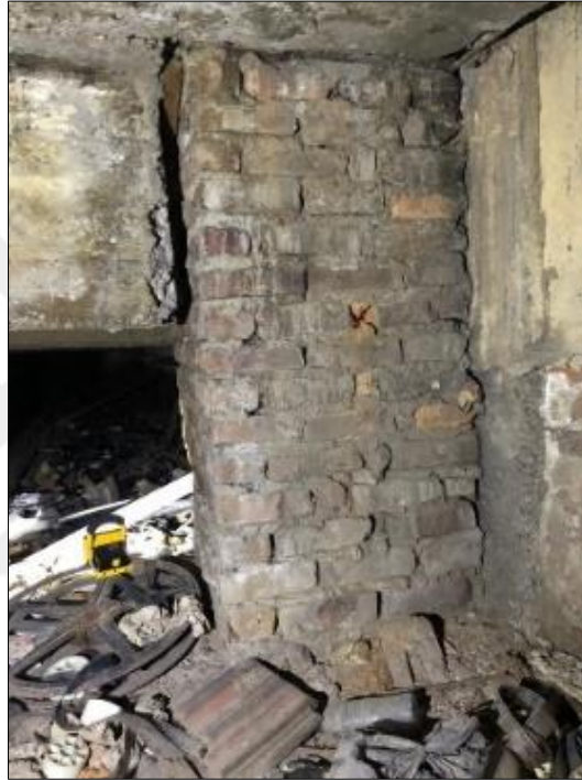
Şekil 4.72. Bacada meydana gelen malzeme kaybı hasarları
