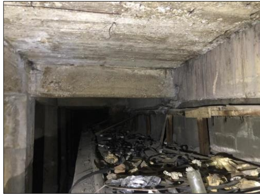
Şekil 4.73. Kiriş duvarda meydana gelen malzeme kaybı hasarları
