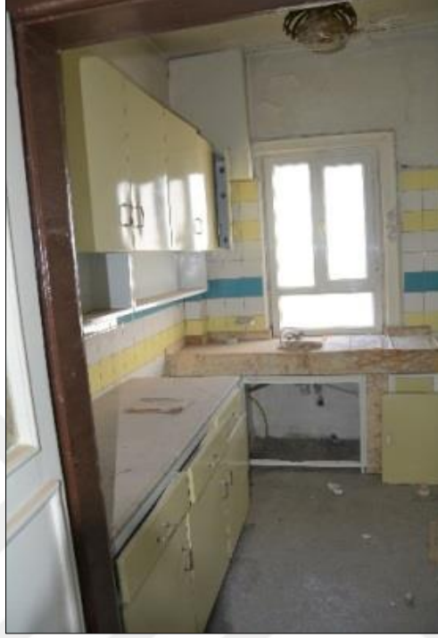
Şekil 4.118. Lojman ve misafirhanede neme bağlı oluşan bozulmalar
