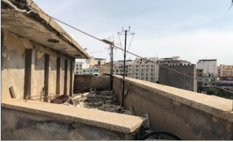
Şekil 4.93. Site Sineması çatı katında ve duvarlarında yağmur sularına bağlı oluşan bozulmalar
