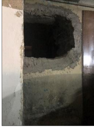
Şekil 4.80. Duvarlardaki doku kaybı hasarları
