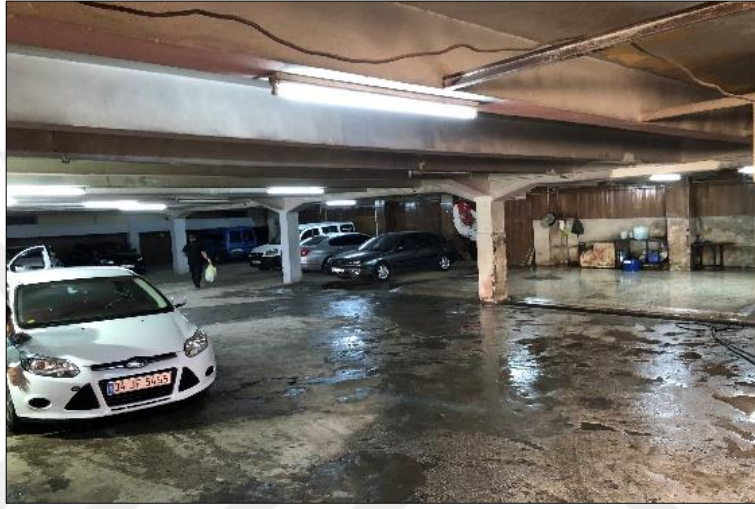
Şekil 4.76. Site Sineması otoparkında döşeme, kolon ve kirişlerde oluşan malzeme kayıpları
