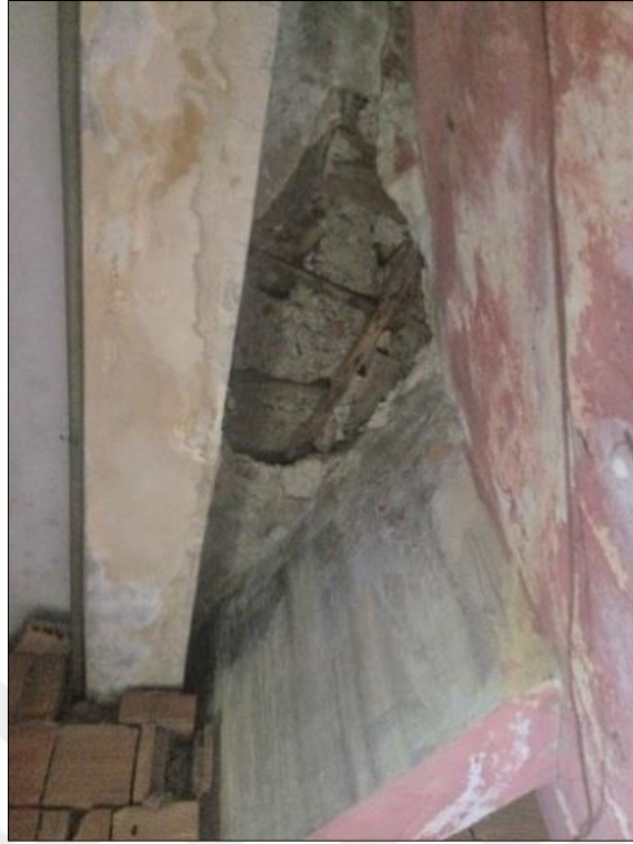
Şekil 4.100. Salon 1 makine dairesinde meydana gelen yüzey ve doku kaybı hasarları
