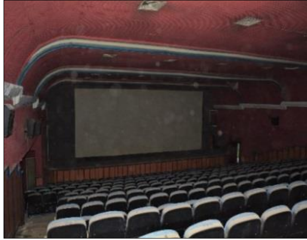
Şekil 4.117. Tavan kaplamasında neme bağlı oluşan bozulmalar
