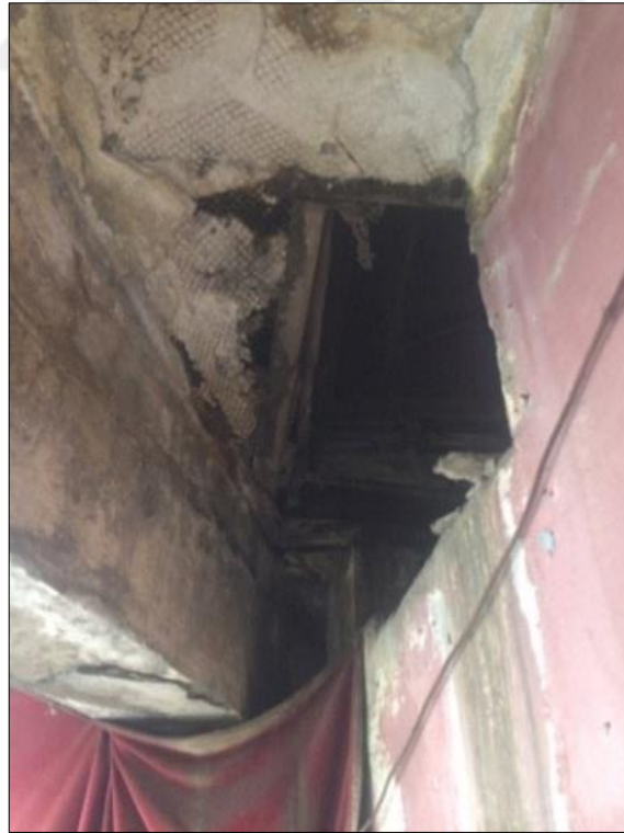
Şekil 4.101. Salon 1 makine dairesinde meydana gelen yüzey ve doku kaybı hasarları
