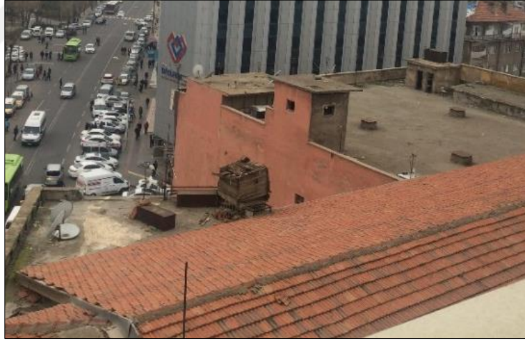
Şekil 4.75. Damda görülen kısmi malzeme kaybı hasarları
