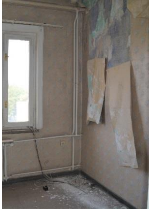
Şekil 4.119. Lojman ve misafirhanede neme bağlı oluşan bozulmalar
