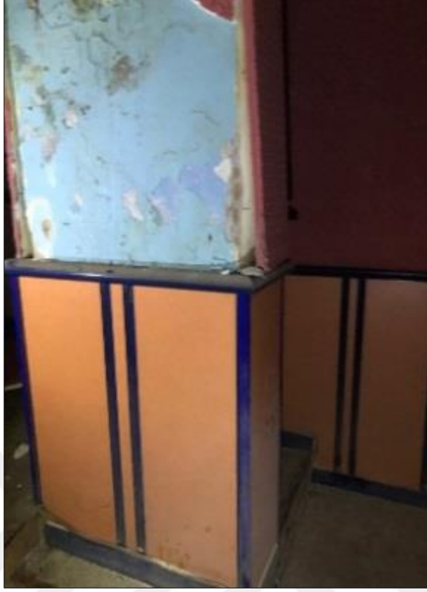
Şekil 4.116. Taşıyıcı kolon kaplamasında neme bağlı oluşan bozulmalar
