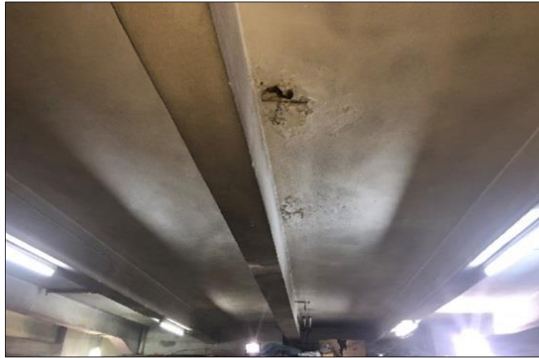
Şekil 4.77. Site Sineması otoparkında döşeme, kolon ve kirişlerde oluşan malzeme kayıpları
