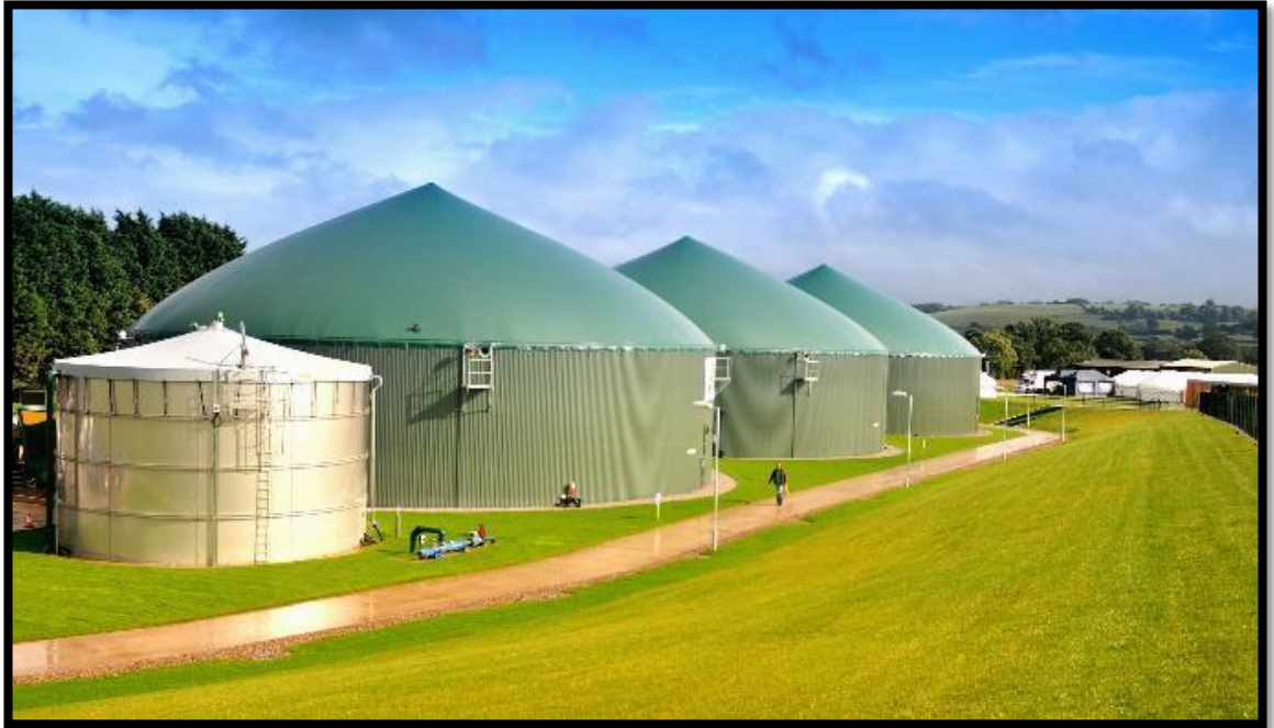
Şekil 2.9. Gaz depolama tankları (Anonim 2017d)
