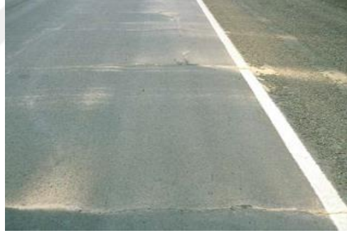
Şekil 1.36. Su sızması ve pompaj [39].
