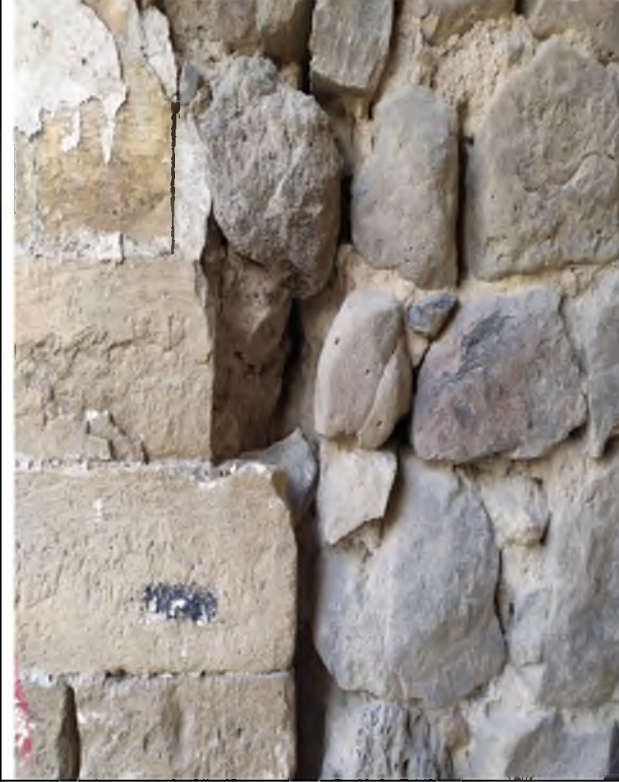
Numune kodu: MK-T5 Alındığı bölge: 2. Kat eyvan (kısmı: güney)
