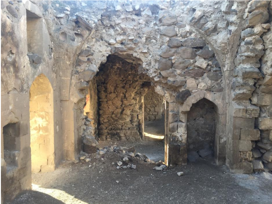
Resim 32: Konuk odasının yıkılan duvarından görünen eyvanlı bölüm.
