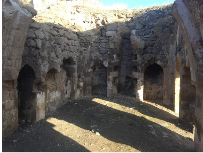
Resim 42. Atmosferik etki ve depremten dolayı 18 nolu konuk odasının çöken üst örtüsünden görünüm.
