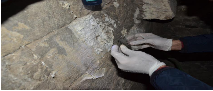
Resim 47: Mezar odası beden duvarında oluşan tuzlanma (Mor Kuryakos Manastırı).
