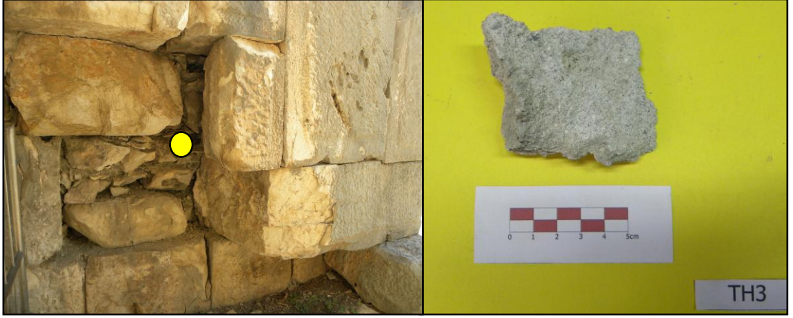
Şekil 3.84. TH3 kodlu taş duvar harcı numunesi
