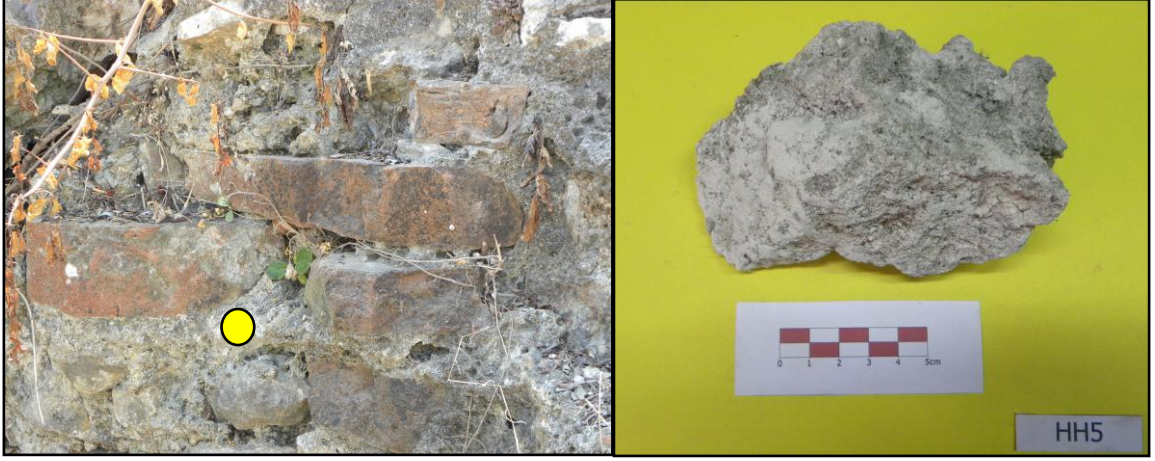
Şekil 3.74. HH5 kodlu tuğla duvar harcı numunesi
