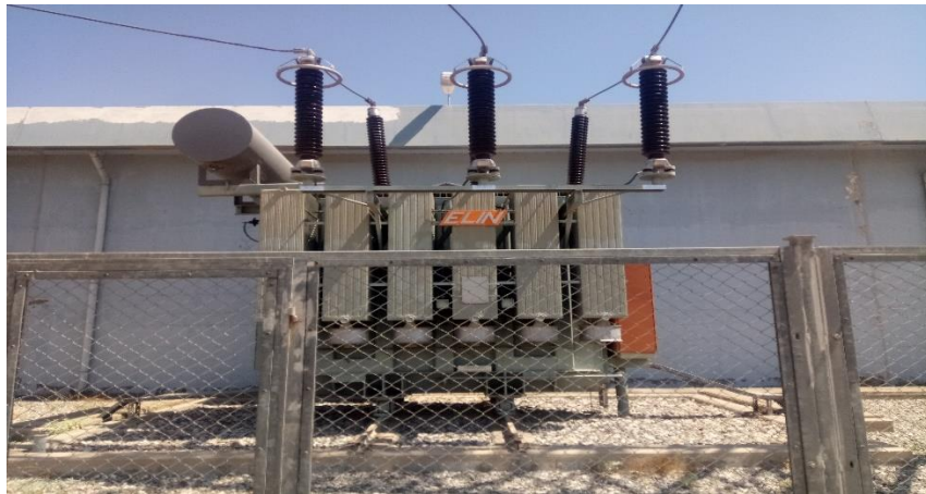
Şekil 14: Karkamış HES Anagüç Trafosu
