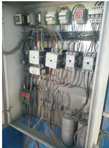
Şekil 3.10. Kuyu pompası kontrol panosu
