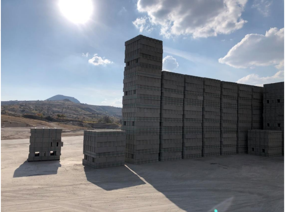
Şekil 3.24. Düzensiz istiflemenin yapıldığı stok sahası yanlış uygulama örneği.
