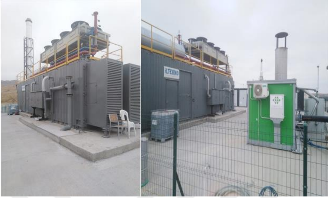
Şekil 4.11 Nevşehir Katı Atık Düzenli Depolama ve Yenilenebilir Enerji Üretim Tesisi.
