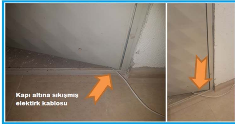
Şekil 6.3. Elektrik kablolarının ortam geçişlerinde kapı altında sıkışmaları durumu
