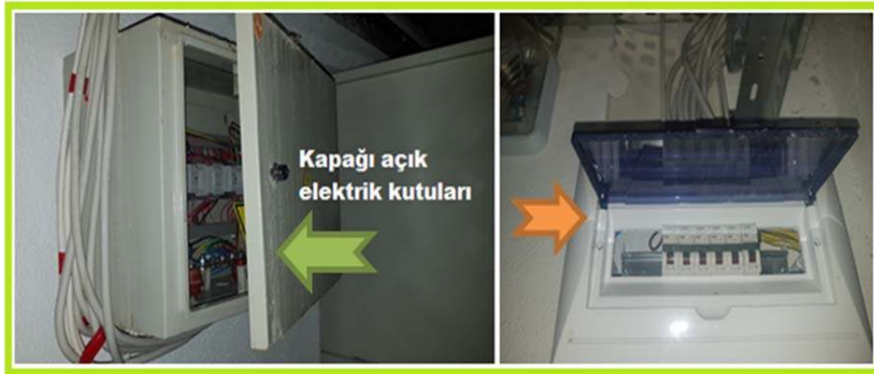
Şekil 6.6.Elektrik pano kapağının açık olması
