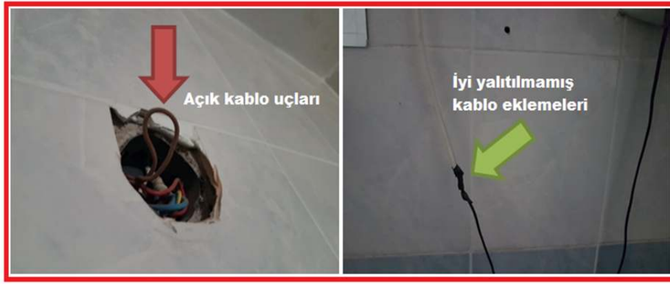
Şekil 6.7. Riskli elektrik kabloları
