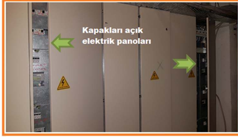
Şekil 6.2. Elektrik pano kapaklarının açık olması durumu
