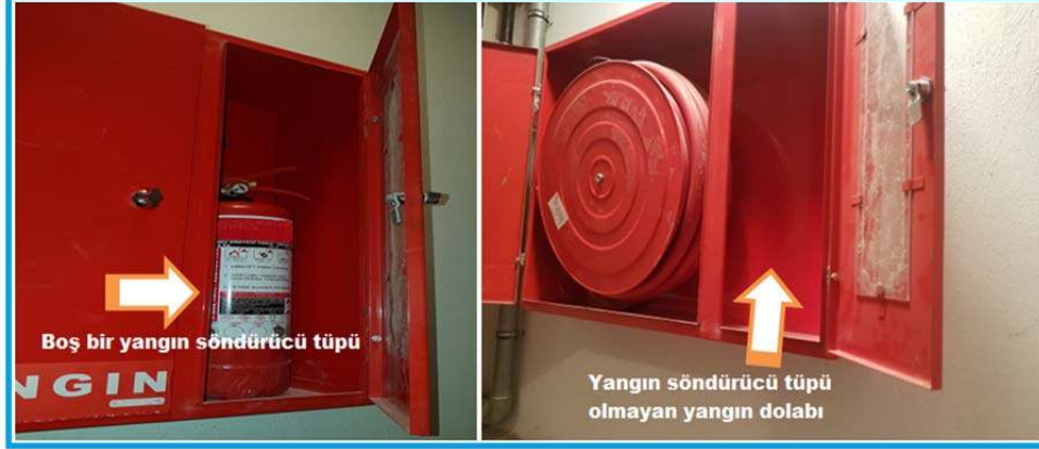
Şekil 6.9. Yangın söndürücü tüpü kontrolleri
