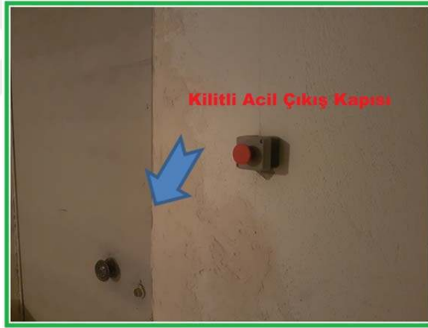
Şekil 6.4. Acil çıkış kapısının kilitli olması durumu
