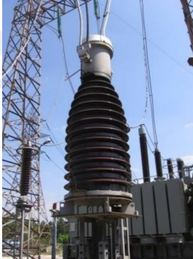
Şekil 2.15. 154 kV seviyesinde kullanılan akım trafoları [32]
