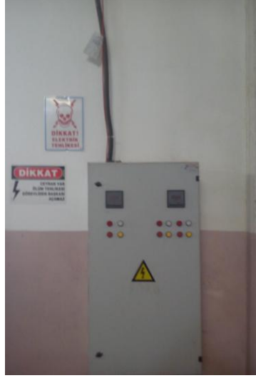
Resim 5.5. Elektrik dağıtım panosu
