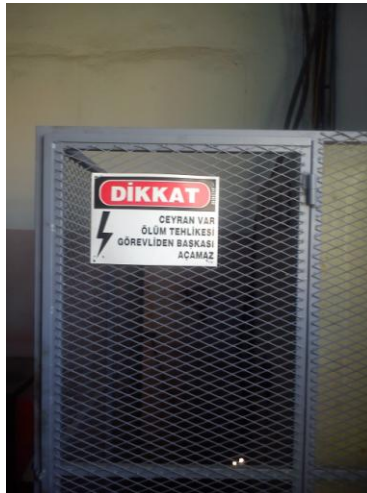
Resim 5.4. Ana elektrik panosu
