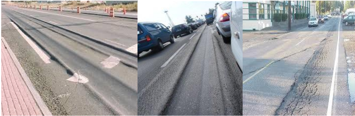
Şekil 4.10. Tekerlek izi deformasyonu
