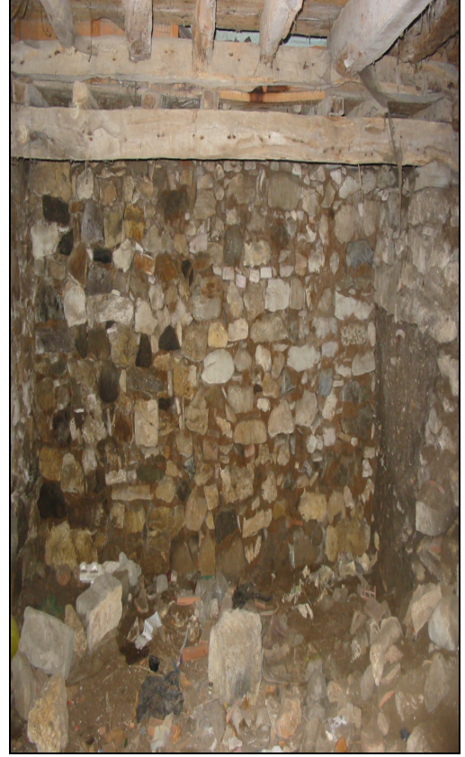
Resim 2.13. B01 d2 duvarı
