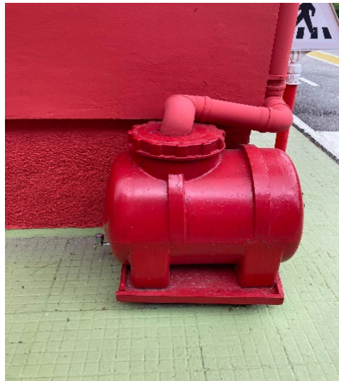
Grsel 2.15. YaĐmur suyu depolama alanı
