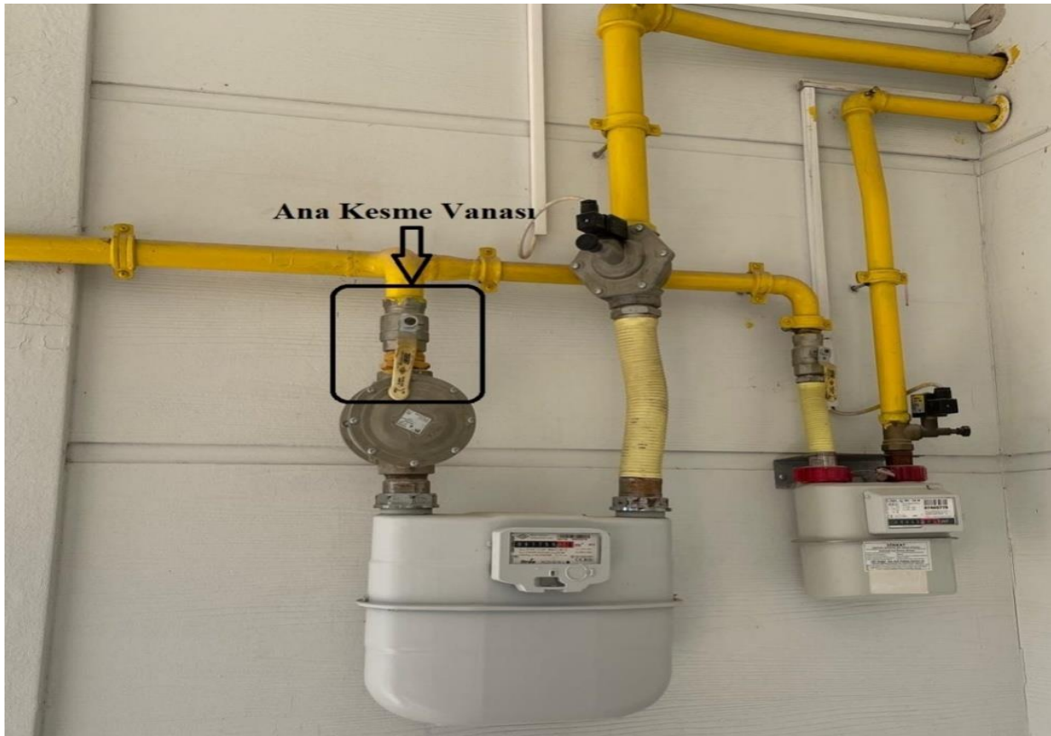
Resim 7.5. Doğal gaz tesisat hattı ana kesme vanası saha örneği
