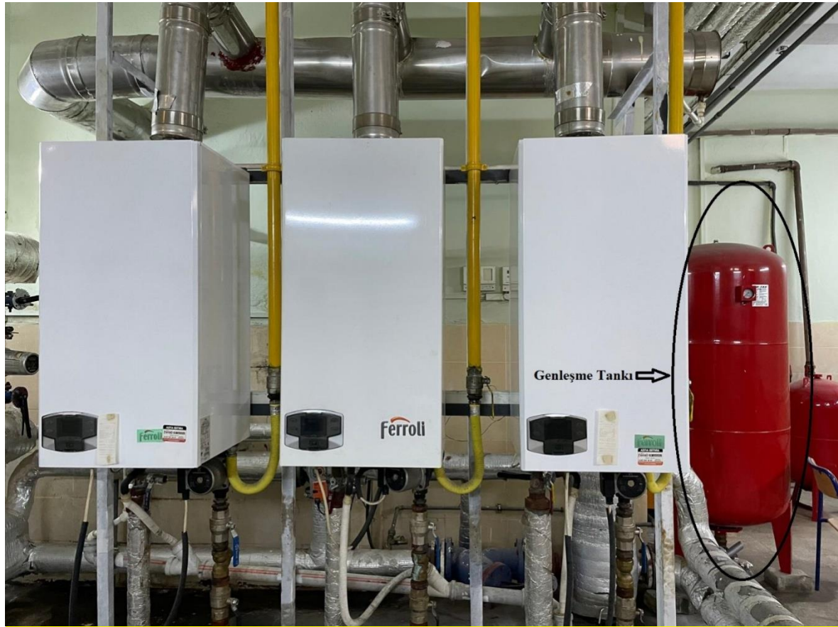
Resim 7.11. Kazan dairesi ısıtma sistemi imbisat tankı uygulaması saha örneği
