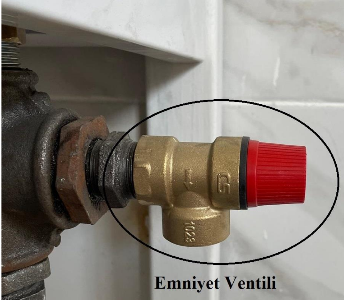
Resim 7.12. Kazan dairesi ısıtma sistemi emniyet ventili uygulaması saha örneği
