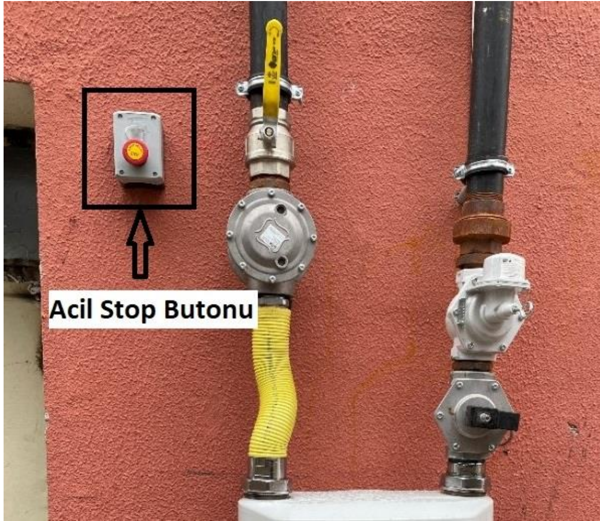
Resim 7.8. Kazan dairesi girişı acil stop butona saha örneđi
