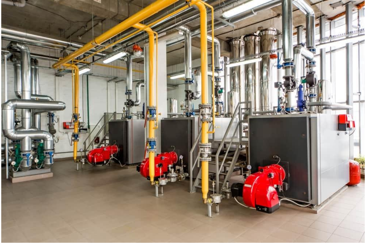
Resim 7.2. Brülörlü (Yer Tipi) ısıtma sistemi kazan dairesiörneği
