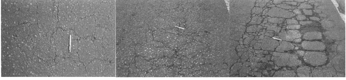
Şekil 1.1. Düşük (a), orta (b) ve yüksek (c) şiddette yorulma çatlakları (KGM 2008)
