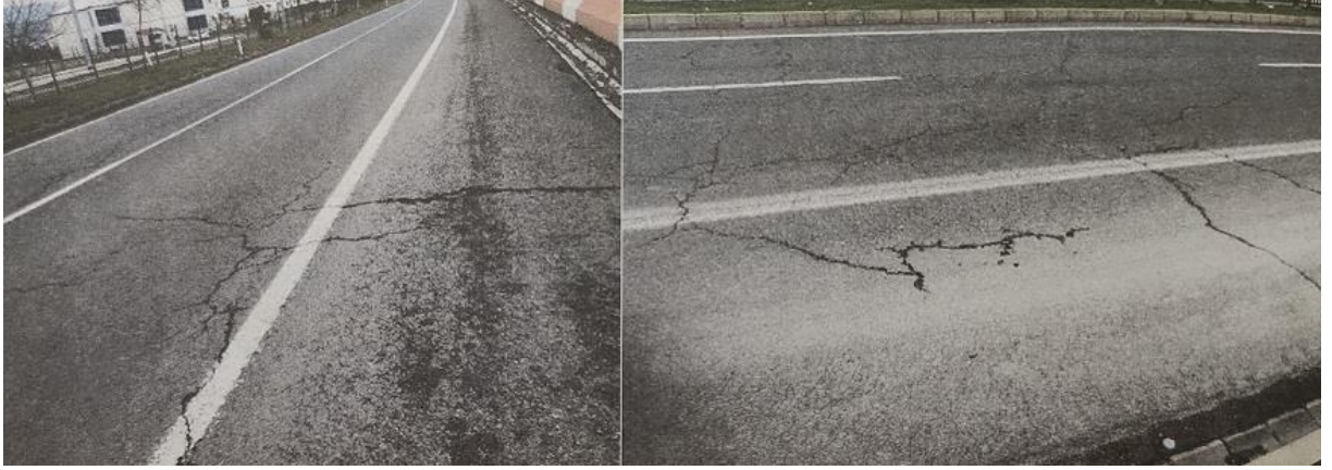
Şekil 1.2. Düşük ısı çatlakları (Kök, 2019)
