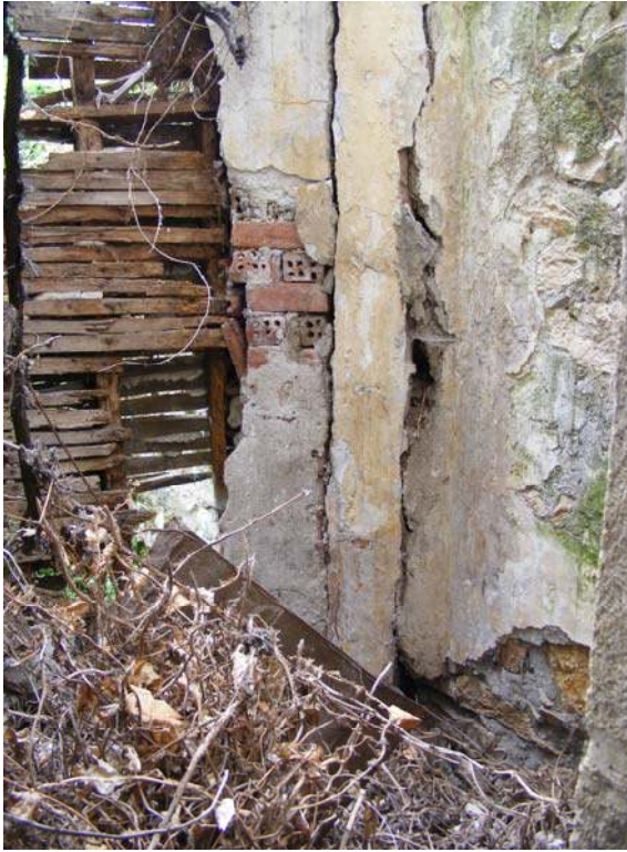
Resim 3.67. Z09 numaralı mekanın yıkık duvar bölümü
