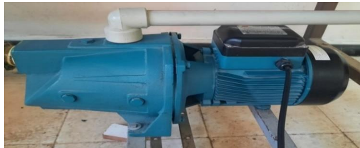
Şekil 3.16. Pompaya bağlı elektrik motoru
