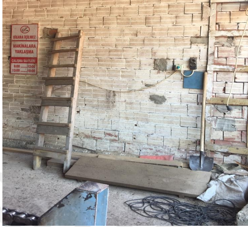
Şekil 64. Elektrik tesisat ve kabloları
