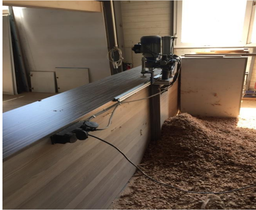
Şekil 40. Elektrik priz ve kabloları
