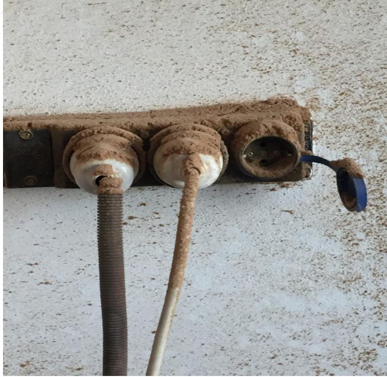
Şekil 53. Elektrik priz ve kabloları
