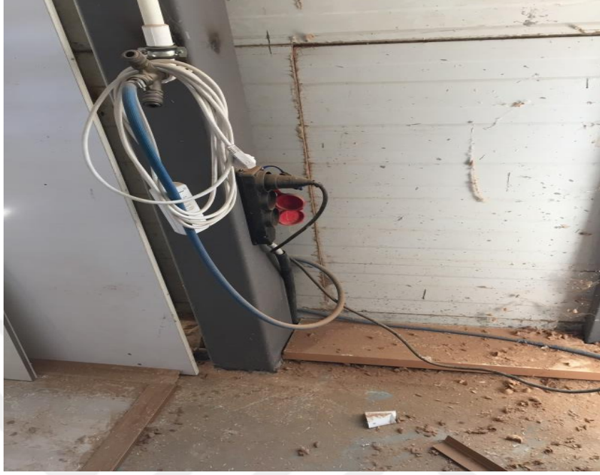
Şekil 39. Elektrik priz ve kabloları
