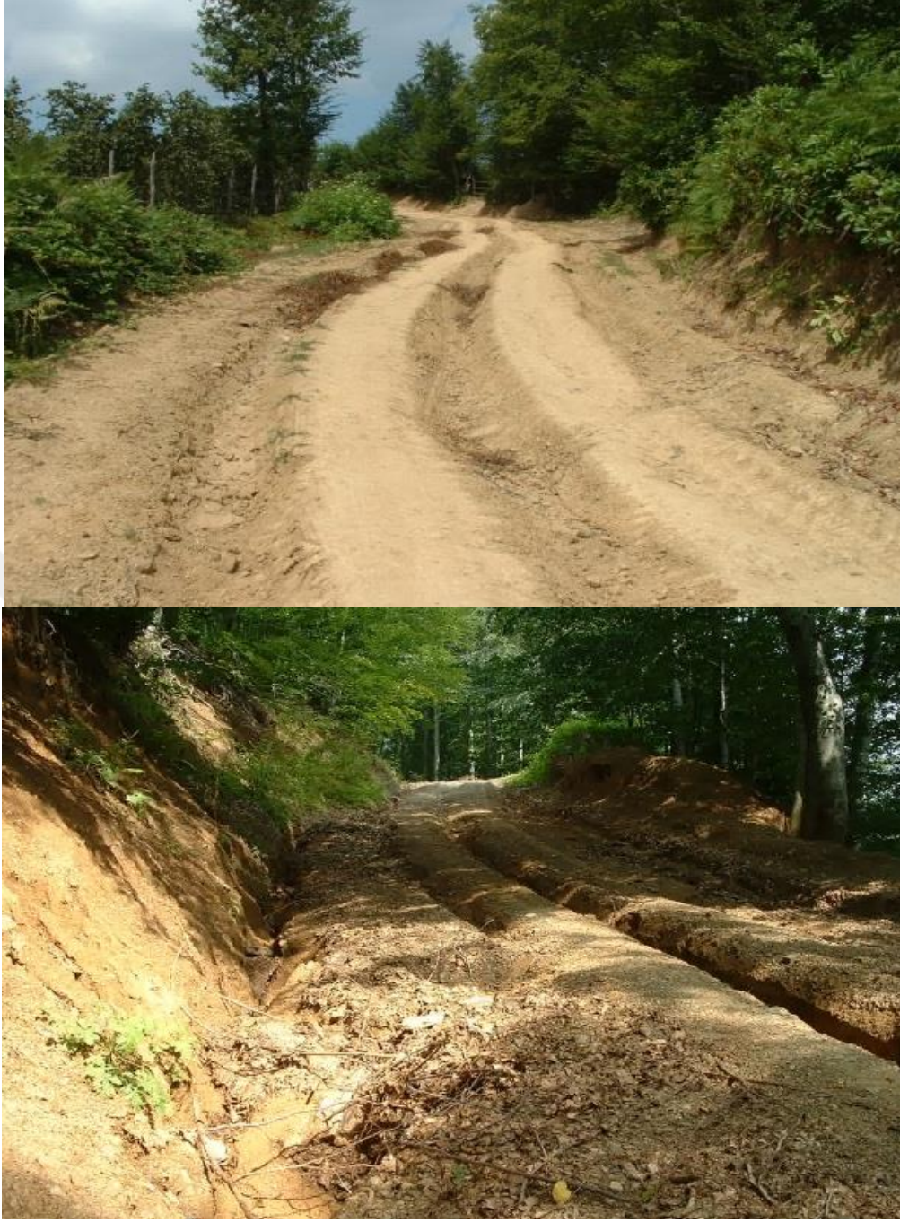
Şekil 1.3. Yol platformundaki bozulmalar.
