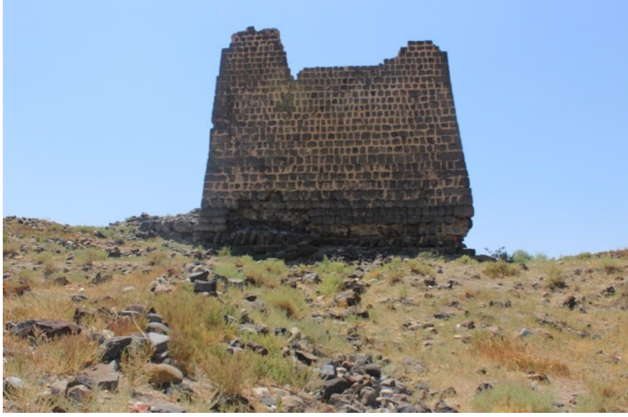
Foto 41. Karakale (Sürmeli Kalesi) Batı Cephesine Bakan Dış Duvar.
