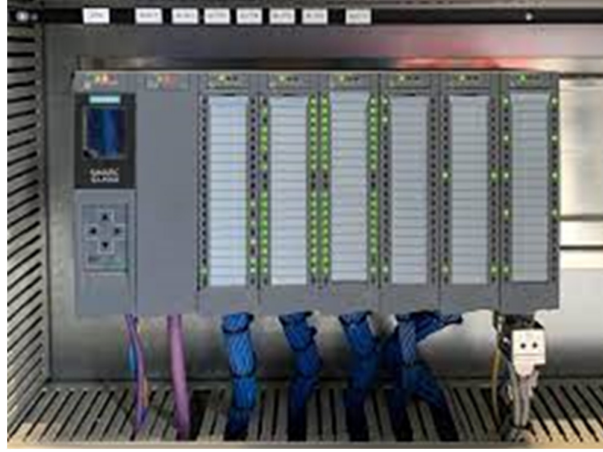
Şekil 4.3. PLC panosu ve Siemens S7-1500 PLC görseli
