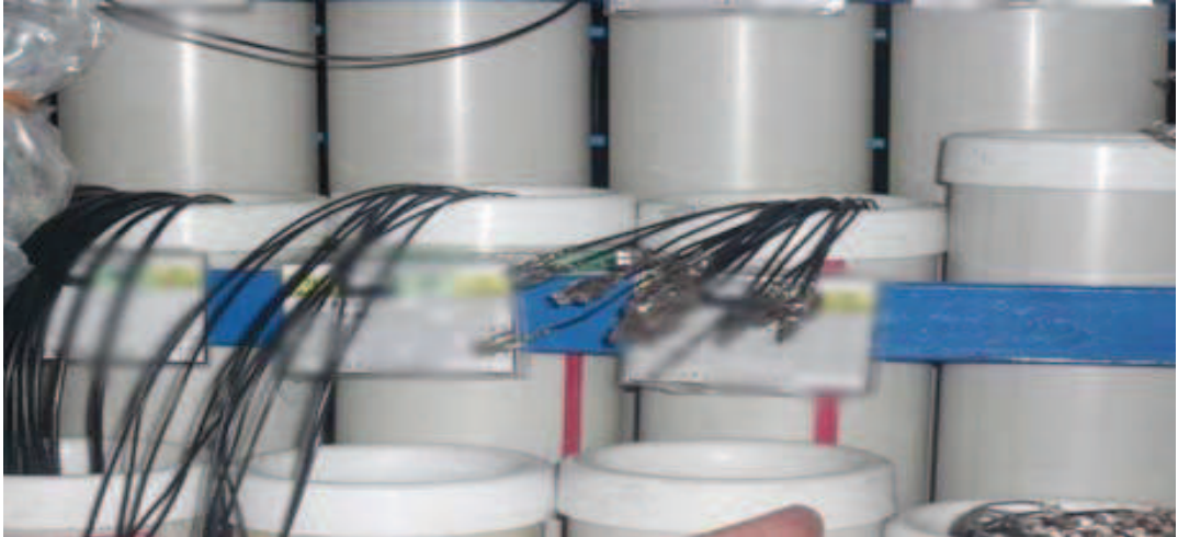
Şekil 4.4. Kablo besleme ünitelerinin iyileştirme öncesi durumu.
