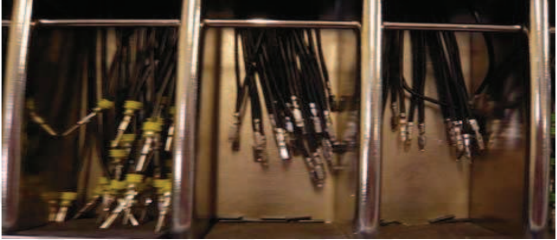
Şekil 4.5. Kablo besleme ünitelerinin iyileştirme sonrası durumu.
