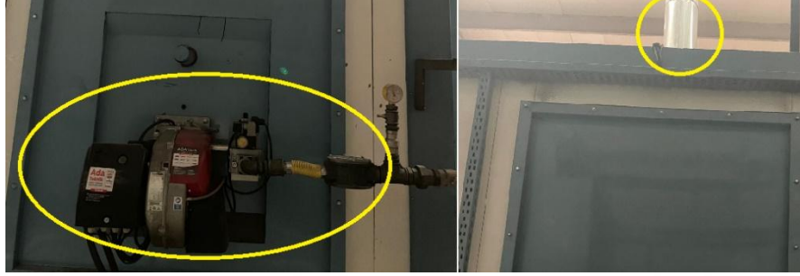
Şekil 4.6. Toz boya pişirme brülör ve bacası.
