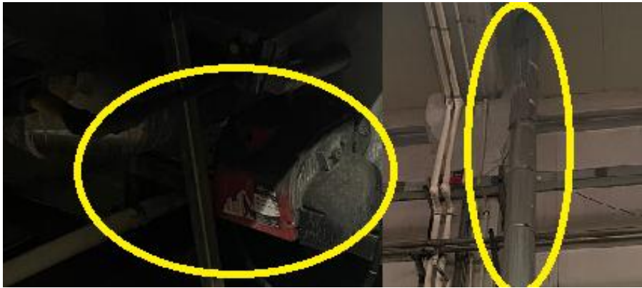
Şekil 4.5. No: 2 Yıkama havuz brülör ve bacası.
