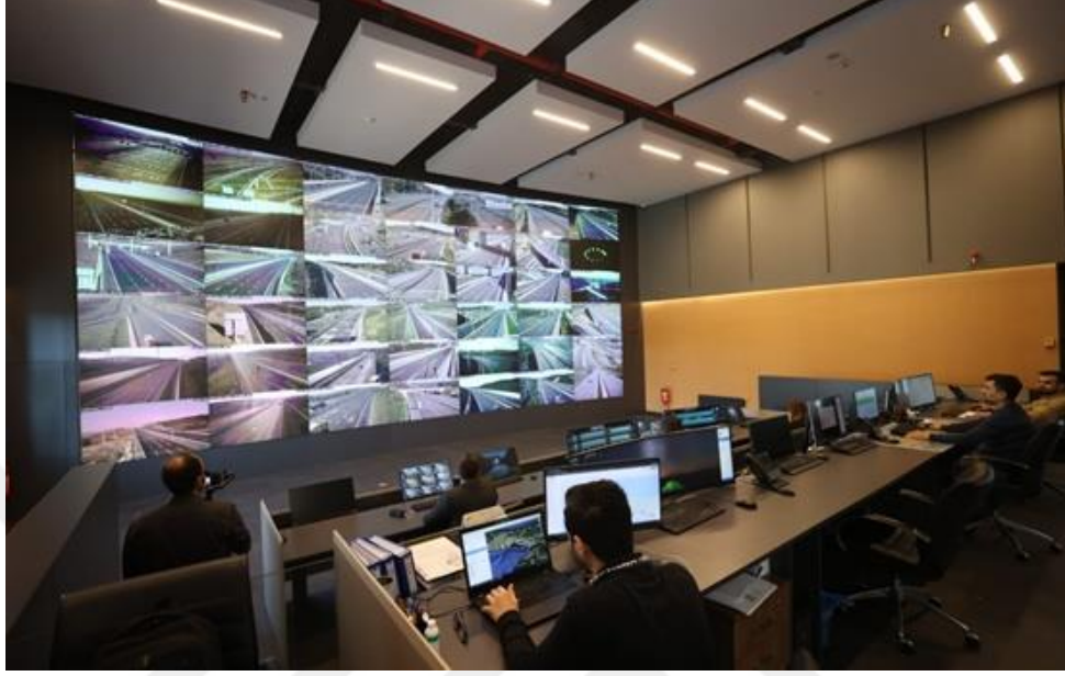
Şekil 4-37: Kuzey Marmara Otoyolu Ana Kontrol Merkezi [134]
