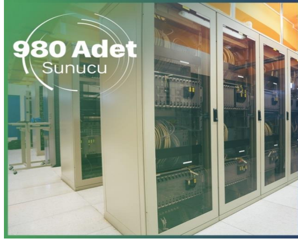
Şekil 4-27: Fiber Altyapı Teknolojisi ile Çalışan Veri Akışını Sağlayan Sunucular [124]
