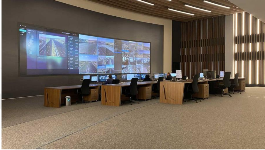
Şekil 4-17: Ankara Niğde Otoyolu SCADA İzleme Merkezi [76]
