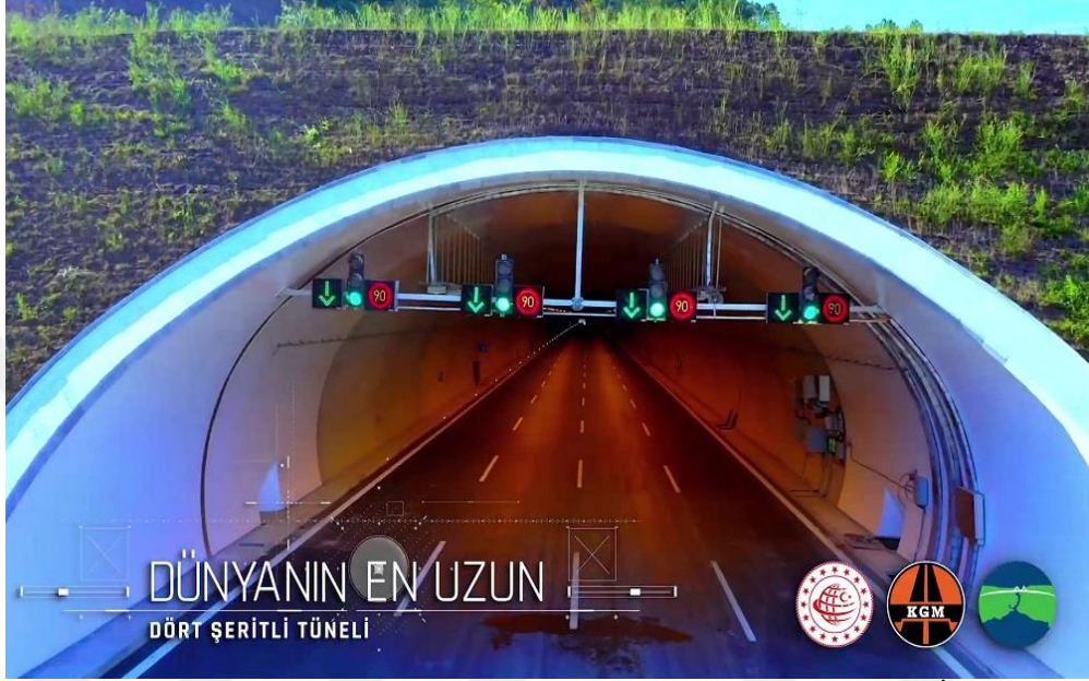
Şekil 4-31: Kuzey Marmara Otoyolu Çatalca T1-T2 Tünelleri Değişken Trafik İşareti [131]
