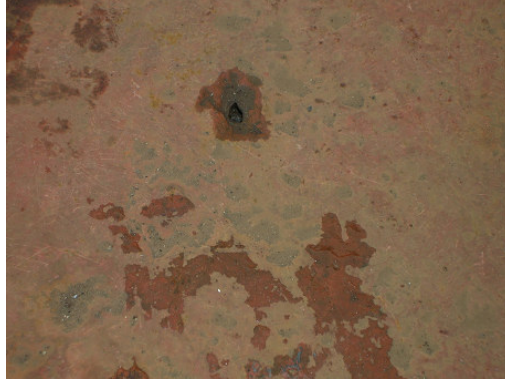
Şekil 6.24 Baş üstü güvertede korozyonlu bölge
