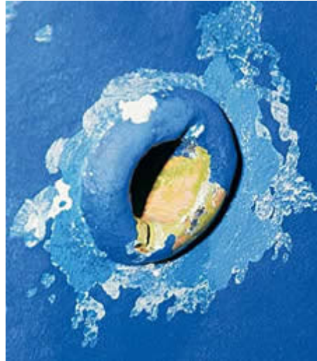
Şekil 2.11 Gemilerdeki boru tesisatında erozyonlu korozyon [11]
