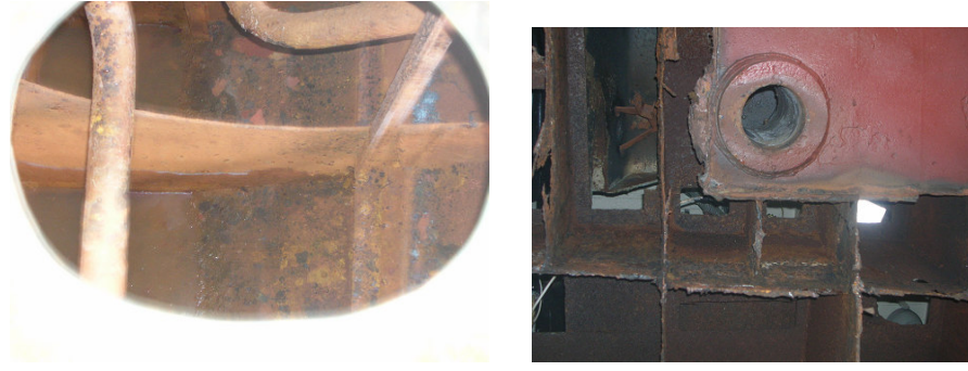
Şekil 6.32 Sintinede oluşan korozyon
