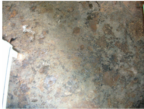
Şekil 6.25 Telsiz kamarası taban sacında korozyon
