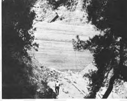
Şekil 34. Büyük bir güvenlik faktörü ile inşa edilmiş çok yüksek bir duvar
