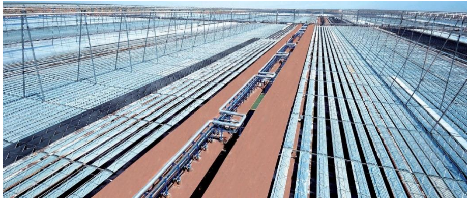
Şekil 3.21. Dhursar doğrusal Fresnel santralinin güneş tarlası (L&T Construction, 2020)
