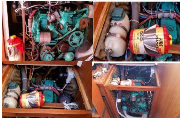
Şekil 1.3. Teknede kullanılan yangın söndürme sistemi [2].
