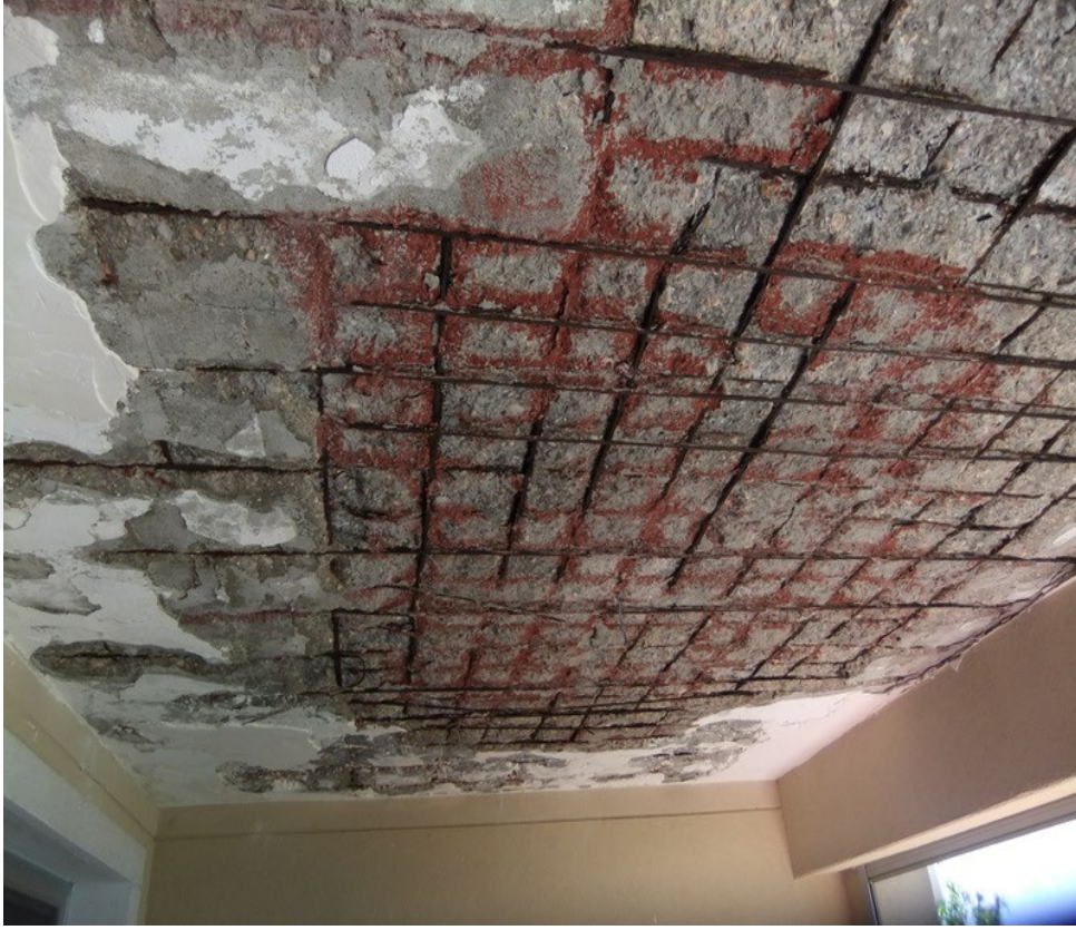
Şekil 2. Döşeme içindeki donatıda oluşan korozyon
