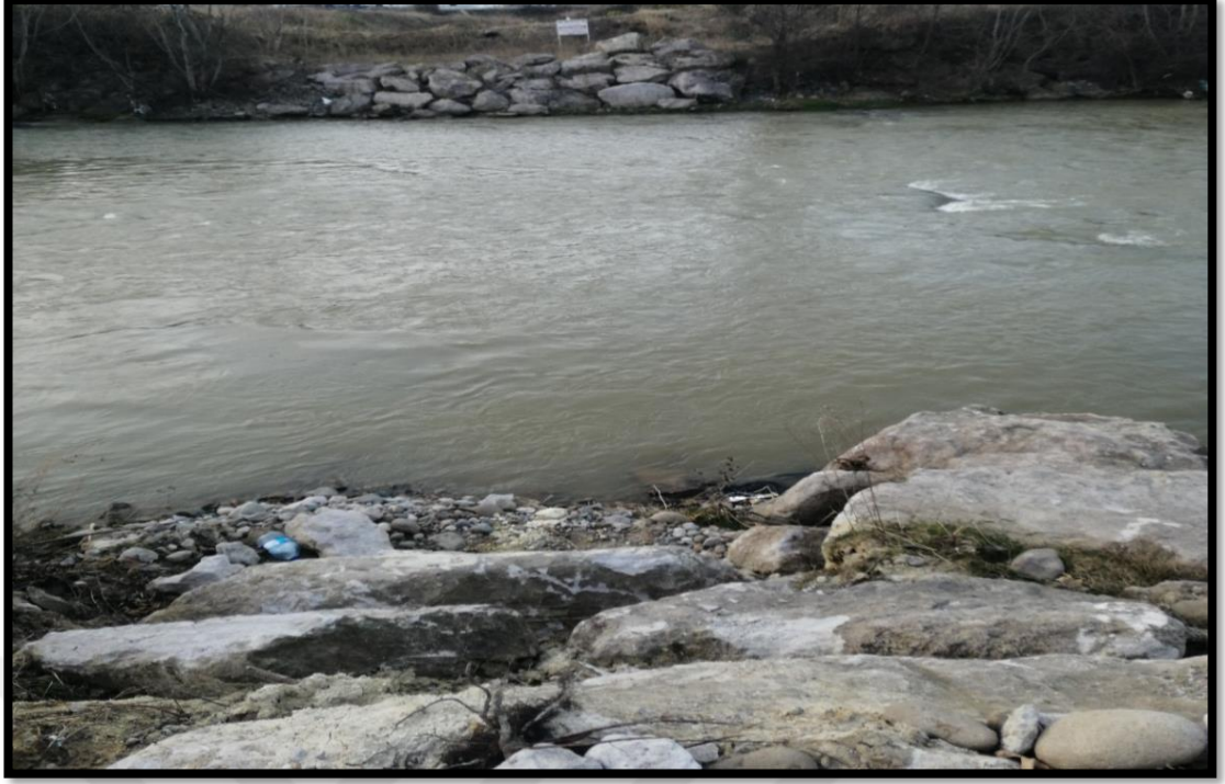
Şekil 5. 21 Pazarsuyu Köyü'nde Elyaslı ve Kirazlık mevki arasında dere yataklarının kaya blokları ile çevrelenmesi (22.01.2023).
