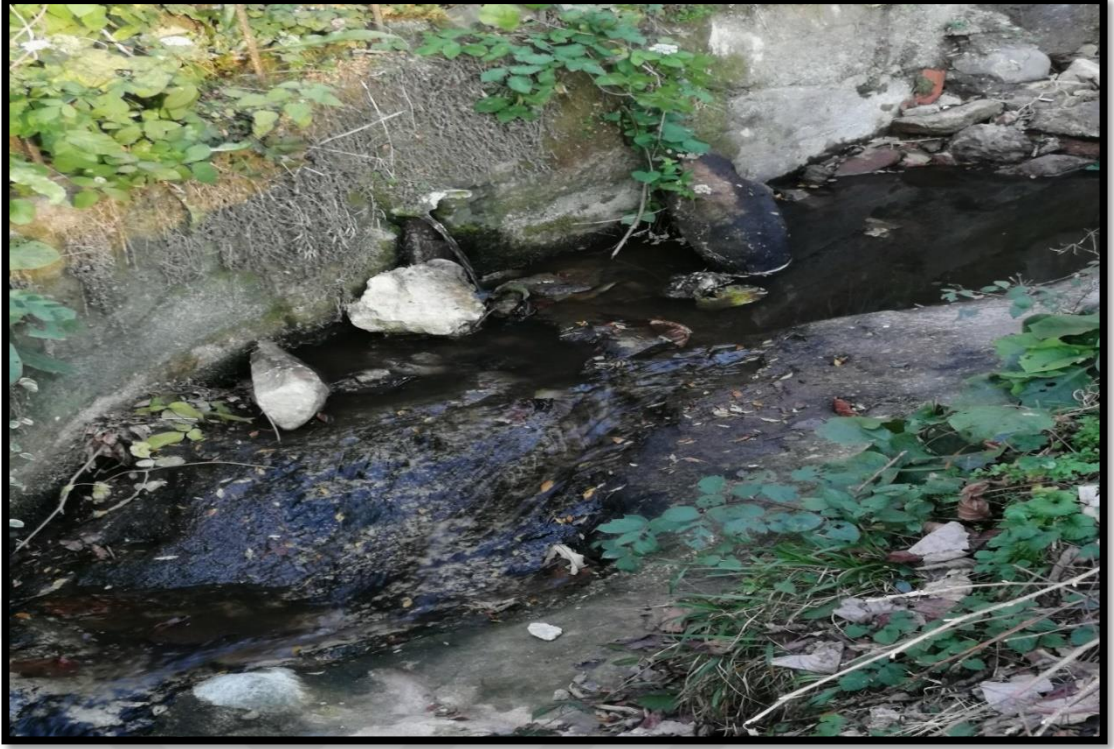
Şekil 5. 16 Pazarsuyu Köyü Elyaslı mevkiinde borulardan çıkan lağım akıntılarının dereye karışması (22.01.2023).
