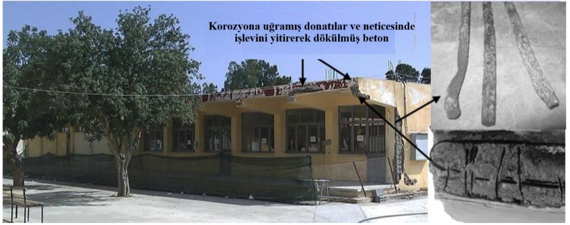
Şekil 1.4. Korozyona maruz kalan betonarme yapının beton pas payının dökülmeye yol açması (Yalçiner vd., 2011).
