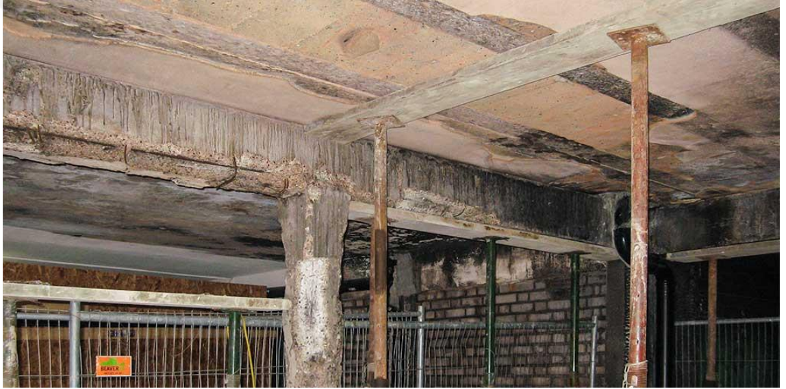
Şekil 1.5. Yangına maruz kalan betonarme yapının kolon ve kirişlerinde betonun işlevini yitirerek dökülmesi (Sandberg, 2024).
