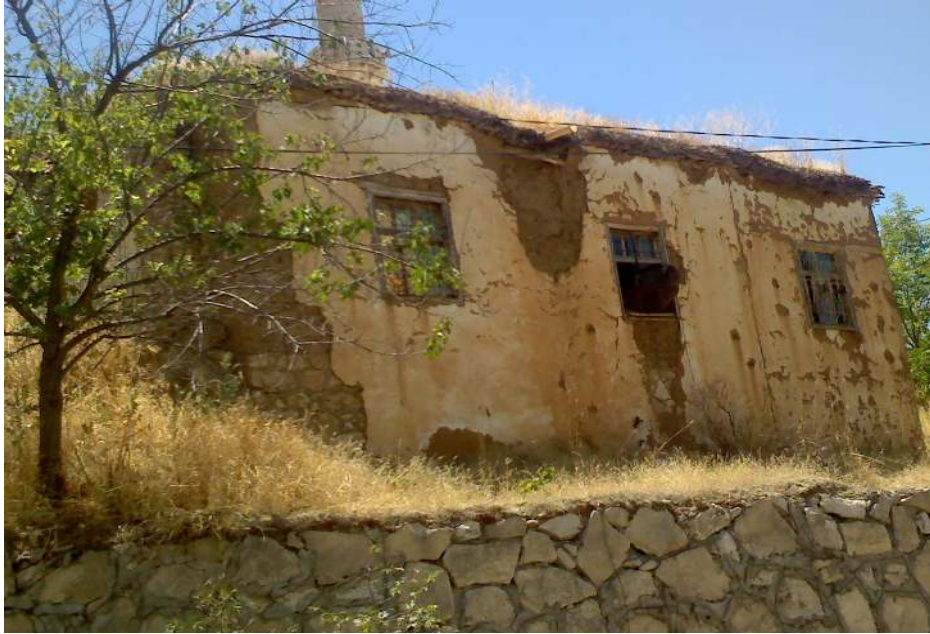
Fotoğraf 23: Kaledibi Mahallesinde Bulunan Kerpiçten İnşa Edilmiş Bir Harabe
