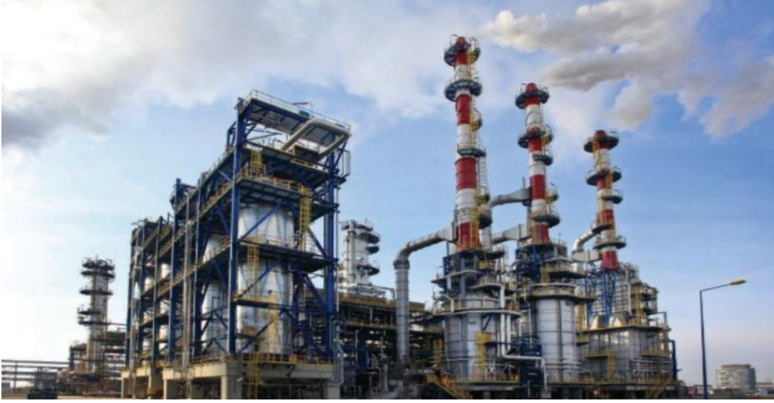
Resim 6. Hydrocracker üretim saha Görünümü
