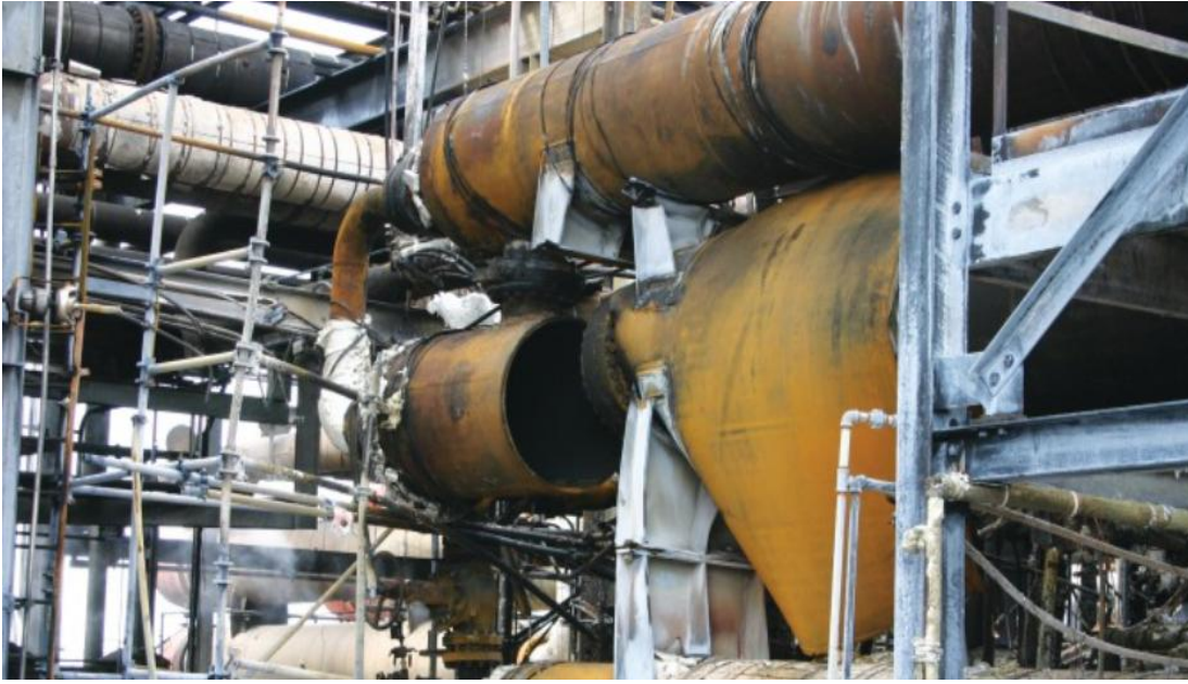
Resim 24. Tesoro Anacortes Rafinerisinde Patlama Sonrası Isı Değiştiricisi
