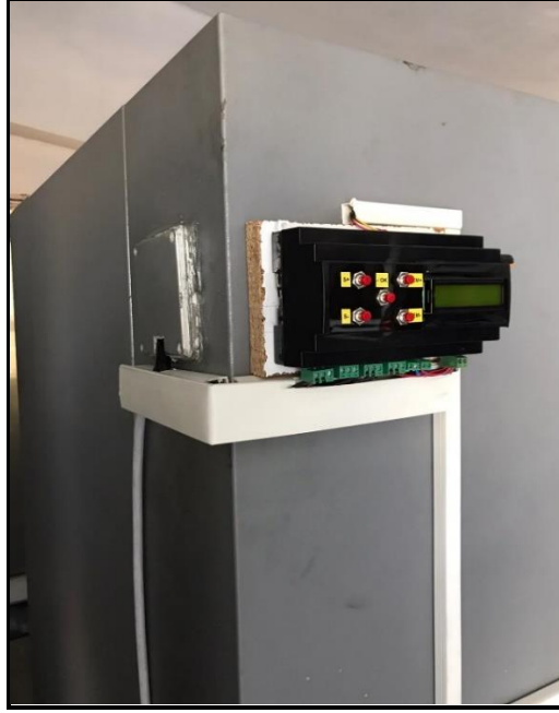
Şekil 3.16. Peynir kurutma makinesi PLC kontrol paneli
