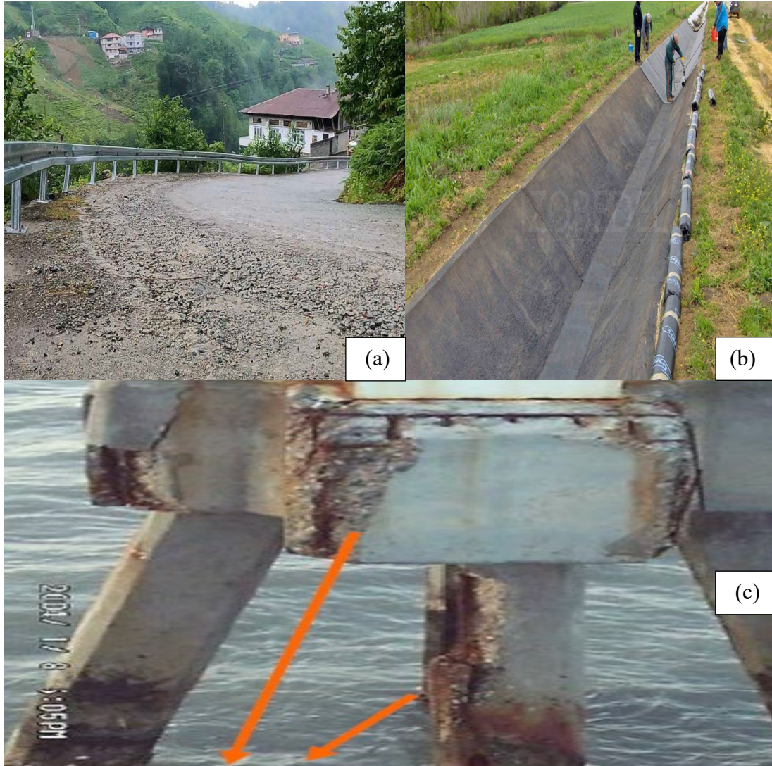
Şekil 1. Aşınma, Erozyon ve Kaviteasyon Hasarları Betonun Fiziksel Etkenlerle Bozulması
