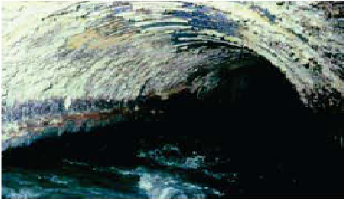
Şekil 3. Asit Etkisiyle ozulmuş Bir Kanalizasyon Tüneli Betonun Kimyasal Etkenlerle Bozulması
