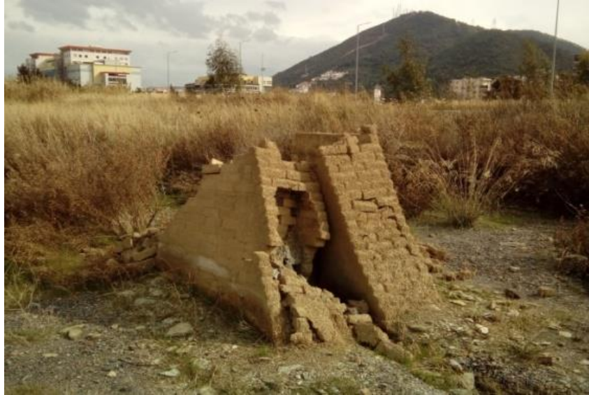
Fotoğraf 114: 2014’de arazide gerçekleştirilen kerpiç projesinin doğal deformasyon sonucu yıkılması
