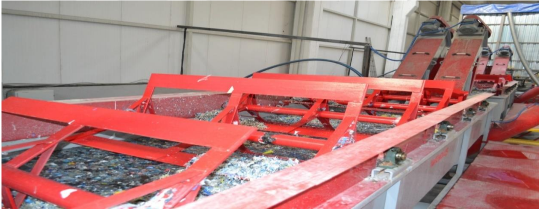
Şekil 4.5. Plastik geri kazanım hattı – yıkama havuzu ünitesi [7].
