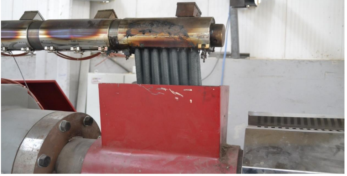
Şekil 4.10. Plastik geri kazanım hattı – enjeksiyon hattı ünitesi [7].
