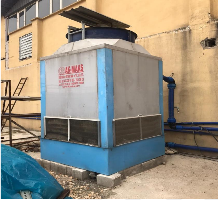
Resim 2.8. Su soğutma kulesi
