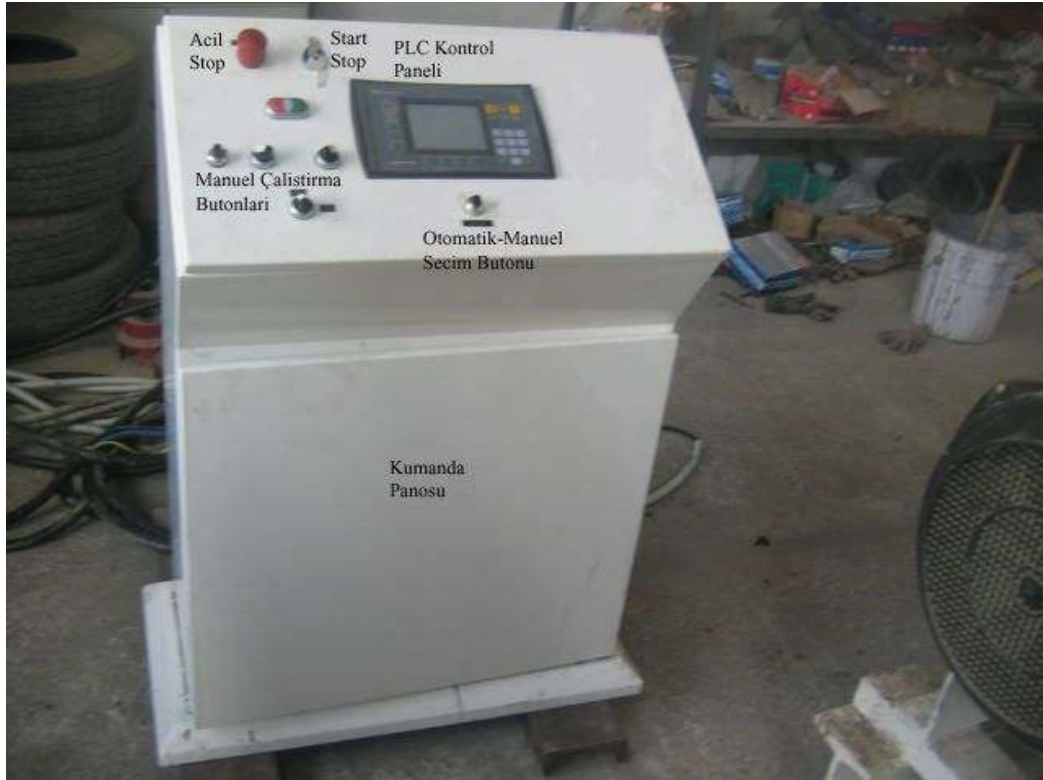
Resim 6.10. PLC Kontrollü vidalı susuzlandırma presi kumanda panosu
